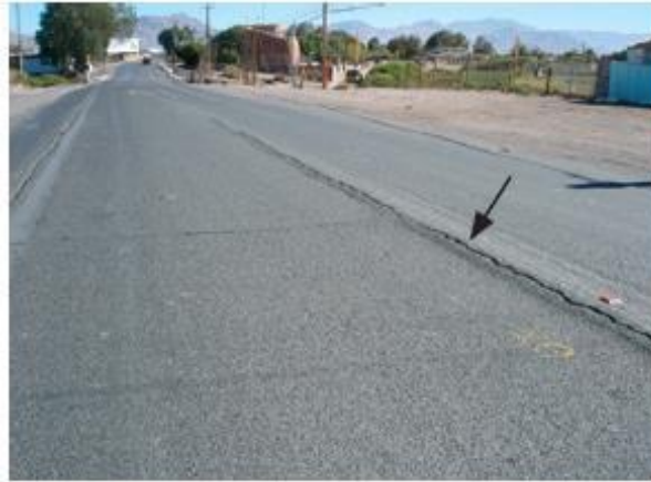
Figura 26 - Trinca de retração (TRR)
