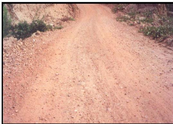
Figura 4 - Exemplo de material desagregado na via
