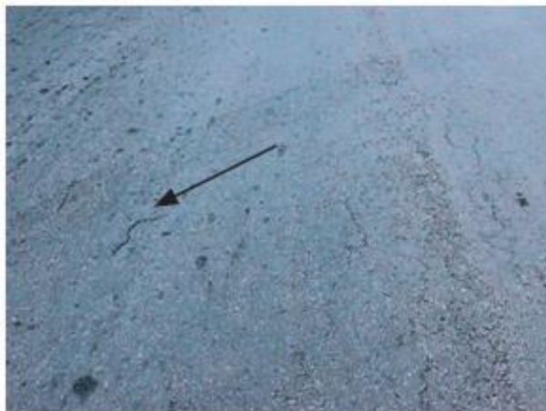
Figura 24 - Trinca longitudinal curta (TLC)
