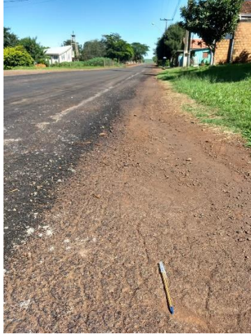
Figura 43 – Couro de jacaré com erosão em trecho pavimentado
