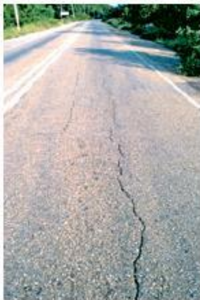
Figura 25 - Trinca longitudinal longa (TLL)
