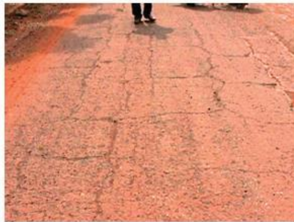
Figura 27 - Trincas de bloco com erosão (TBE)
