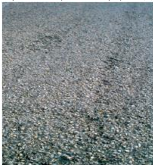
Figura 34 - Desgaste ou desagregação (D)
