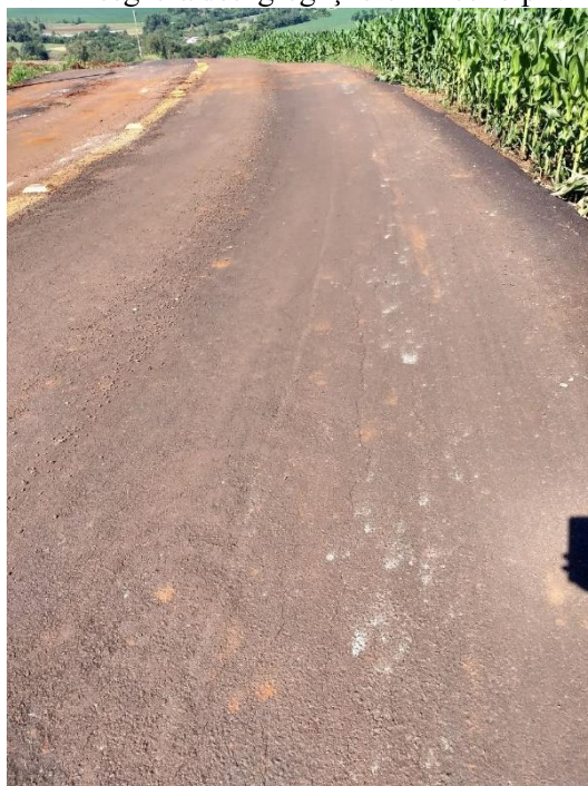
Figura 40 – Desgaste/desagregação em trecho pavimentado
