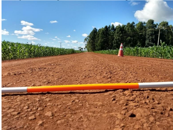
Figura 41 – Depressão em trecho não pavimentado
