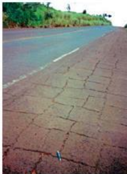
Figura 28 - Trincas de bloco (TB)
