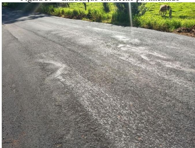
Figura 39 – Exsudação em trecho pavimentado
