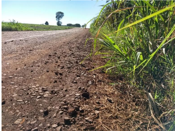
Figura 42 – Indícios de drenagem impropria em trecho não pavimentado
