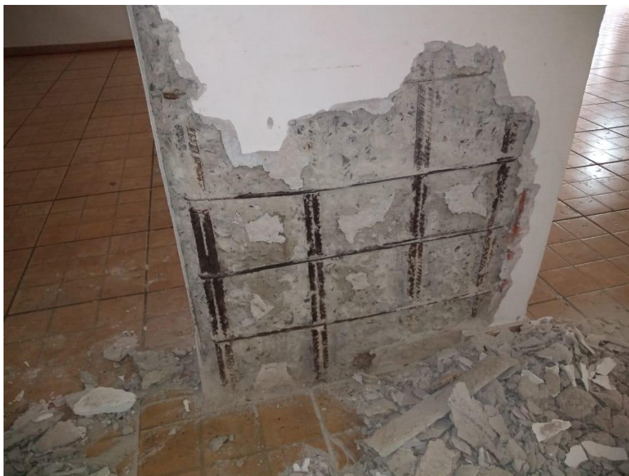
Figura 6: Corrosão da Armadura de um Pilar Estrutural devido à Infiltração.
