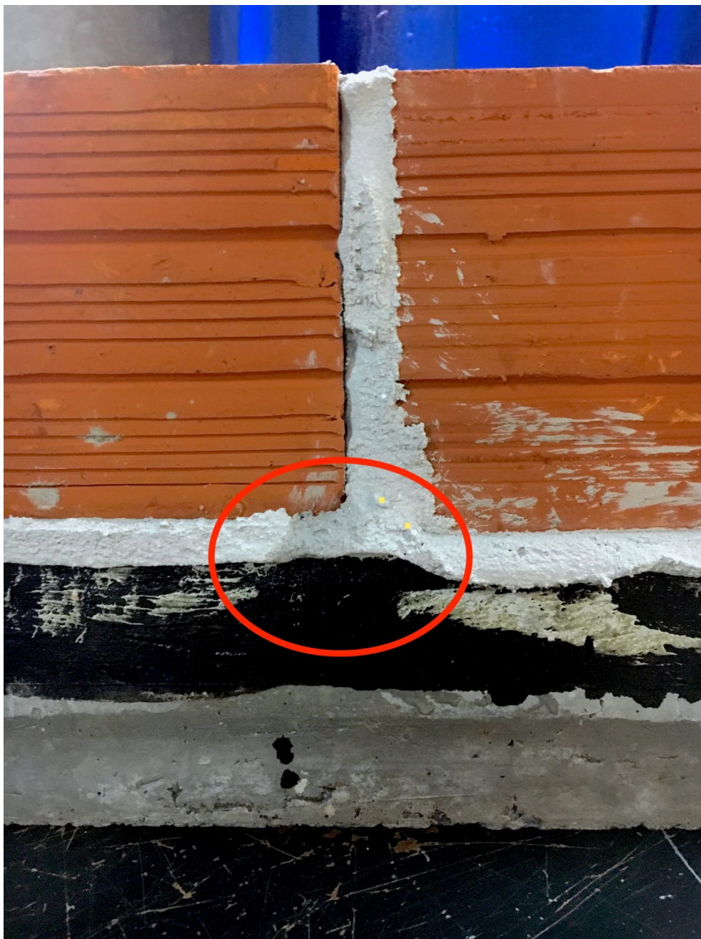
Figura 12 - Falha na impermeabilização
