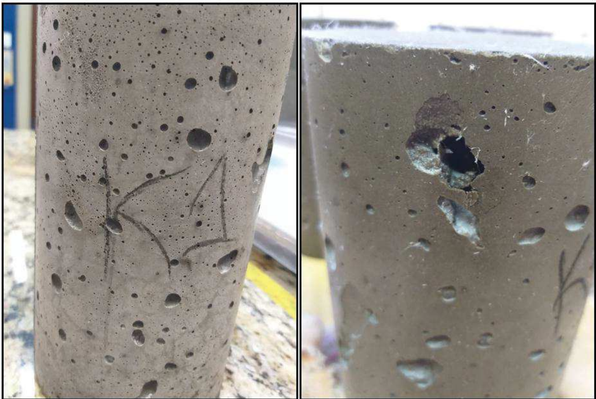
Figura 16: Concreto K1 no estado endurecido e a presença de vazios de concretagem
