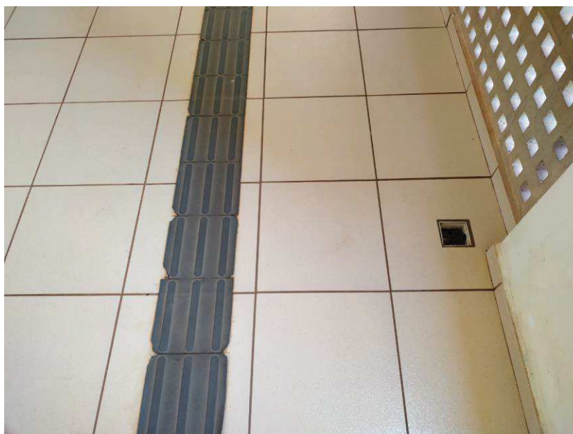
Fotografia 24 – Ralo sem tampa
