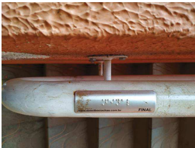
Fotografia 11 – Sinalização tátil no corrimão
