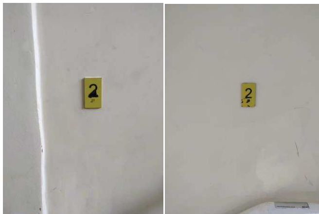
Fotografia 18 – Sinalização de parede desgastada
