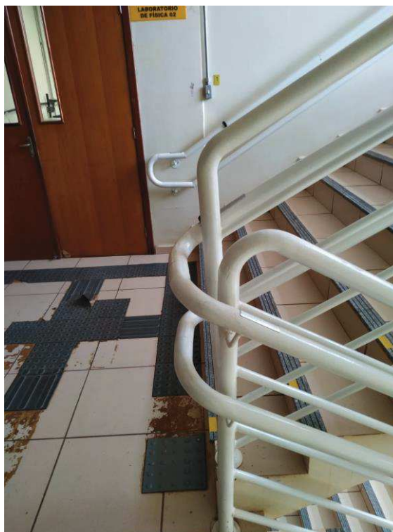
Fotografia 19 – Piso tátil desgastado próximo à escada
