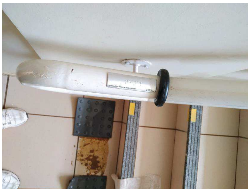
Fotografia 16 – Sinalização tátil no corrimão
