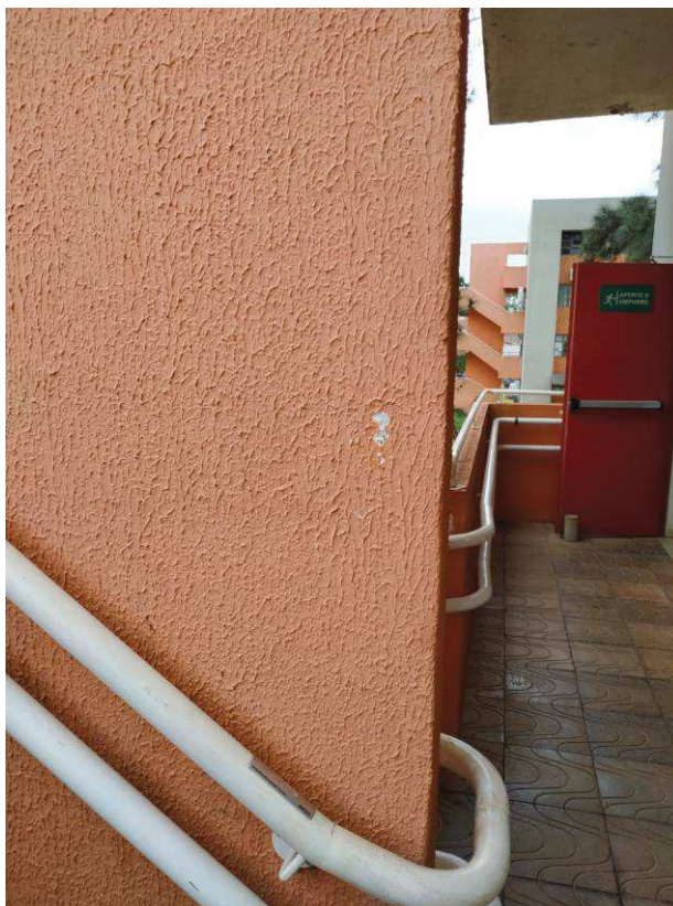
Fotografia 15 – Ausência da sinalização da parede e área sem piso tátil
