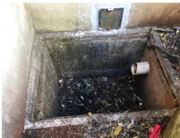
Figura 14 - Caixa de concreto ligada à rede pública
