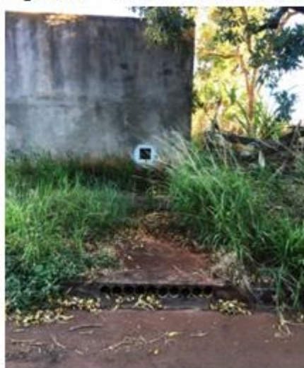
Figura 15 - Tubos PVC para escoamento da água pluvial
