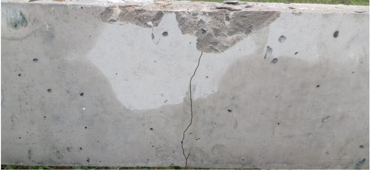
Figura 47: Viga com a armadura de cisalhamento a 45° após 2 impactos – lado A, com a fissura em evidência.
