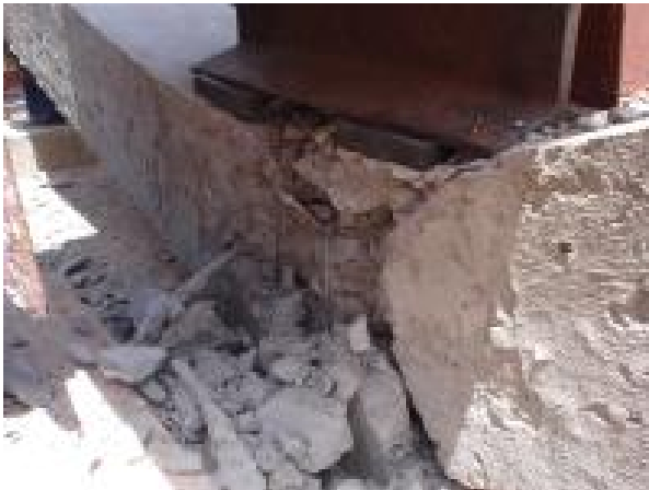
Figura 13: Ruptura da viga com martelo solto a 250 cm.
