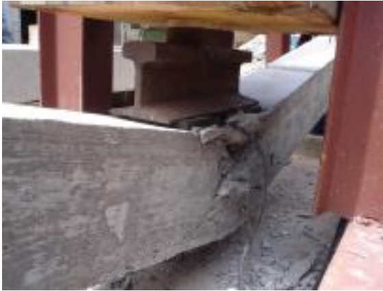
Figura 12: Ruptura da viga com martelo solto a 200 cm.
