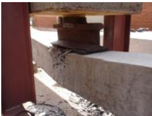
Figura 11: Ruptura da viga com martelo solto a 150 cm.
