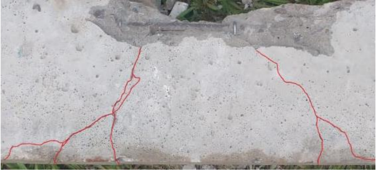
Figura 44: Viga com a armadura de cisalhamento a 90° após 7 impactos – lado A, com fissuras em evidência.
