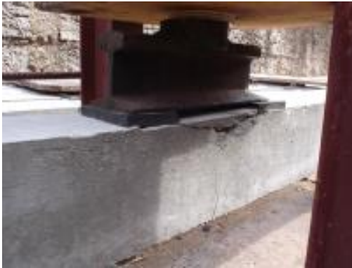
Figura 9: Ruptura da viga com martelo solto a 50 cm.
