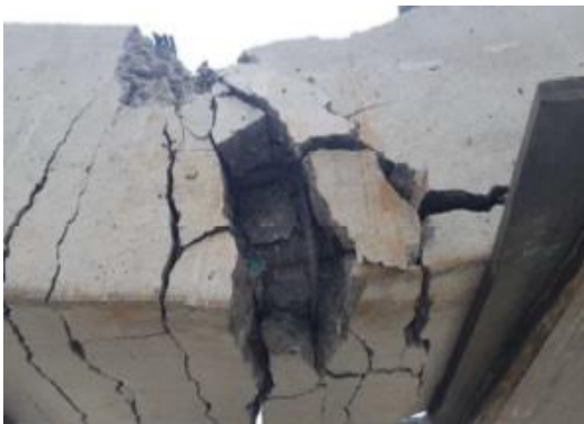
Figura 22: Modo de falha da viga de concreto armado não reforçada.
