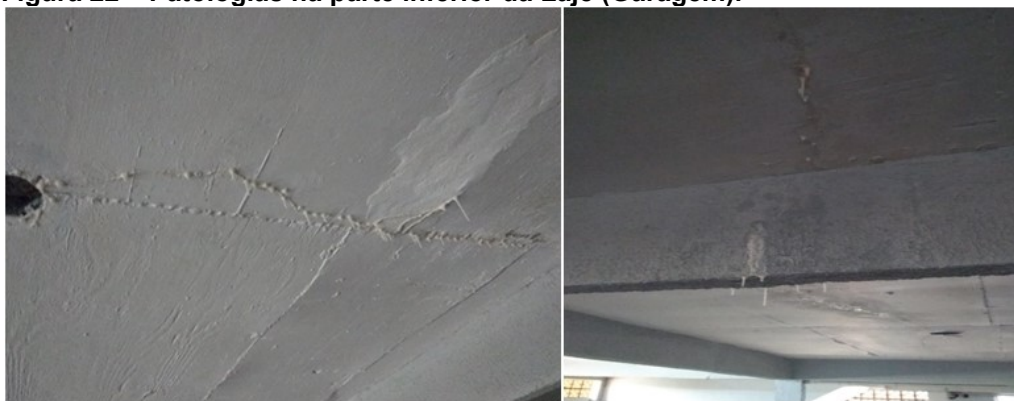
Figura 22 – Patologias na parte inferior da Laje (Garagem).
