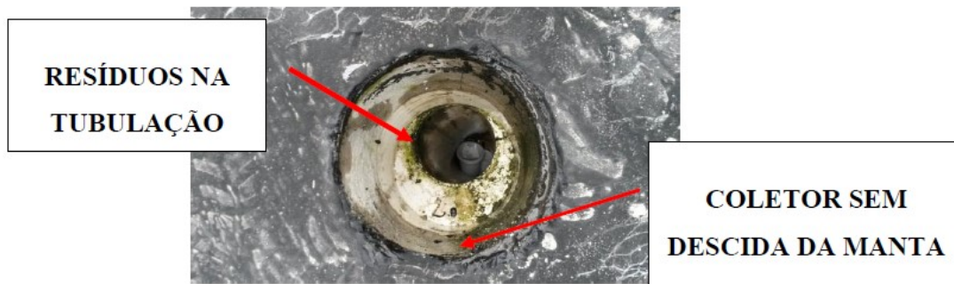
Figura 6 - Falha construtiva: Coletor sem impermeabilização.
