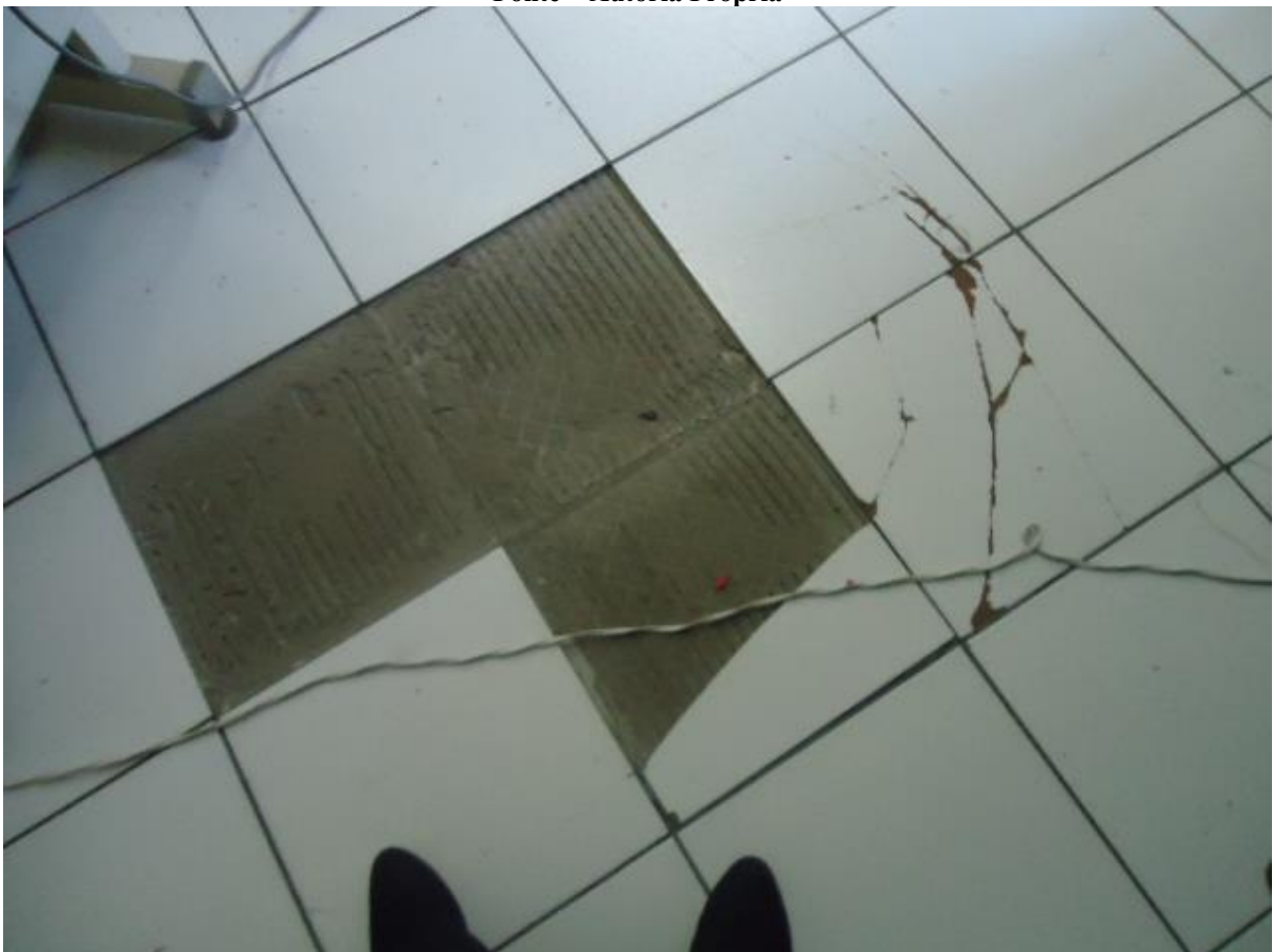
Figura 4 – Defeito no piso de circulação entre os equipamentos Fonte – Autoria Própria
