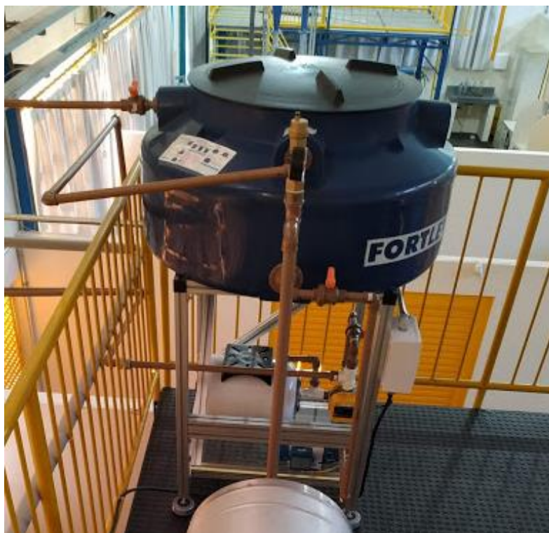
Fotografia 8 - Tubulação de água fria
