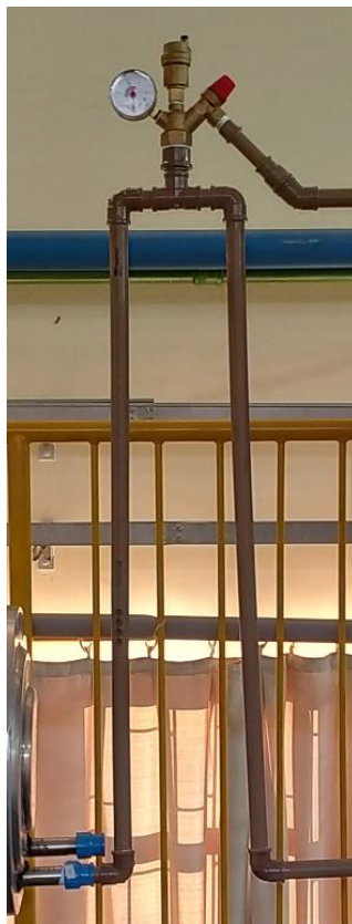
Fotografia 7 - Cavalete com válvula de segurança e manômetro
