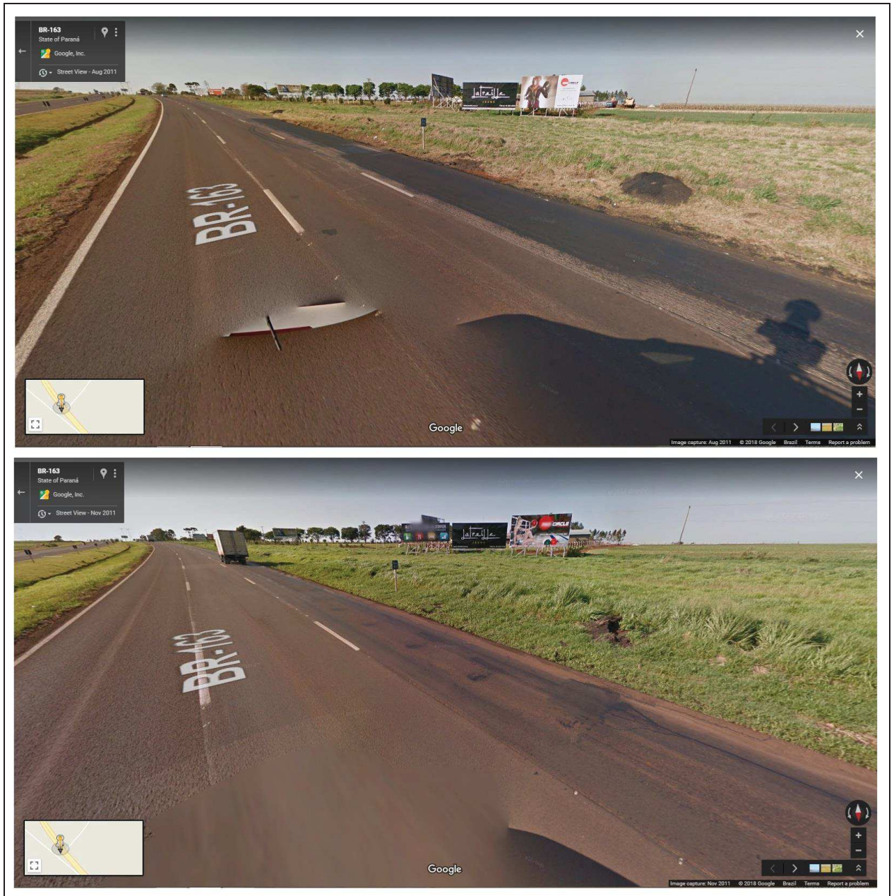
Figura 22 — Intervenções de reparação frequentes no trecho entre o km 80,0 e o km 84,0 da rodovia BR-467 no sentido Toledo-Cascavel.
