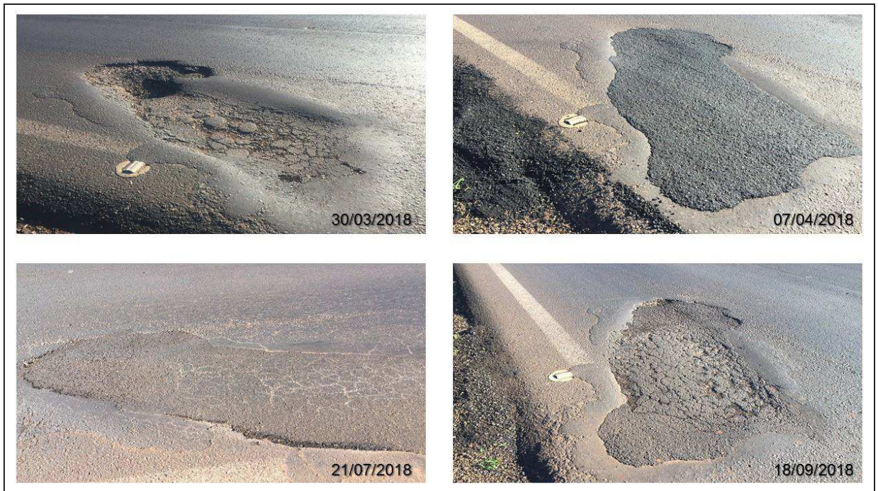
Figura 21 — Série histórica de patologias diversas no pavimento.
