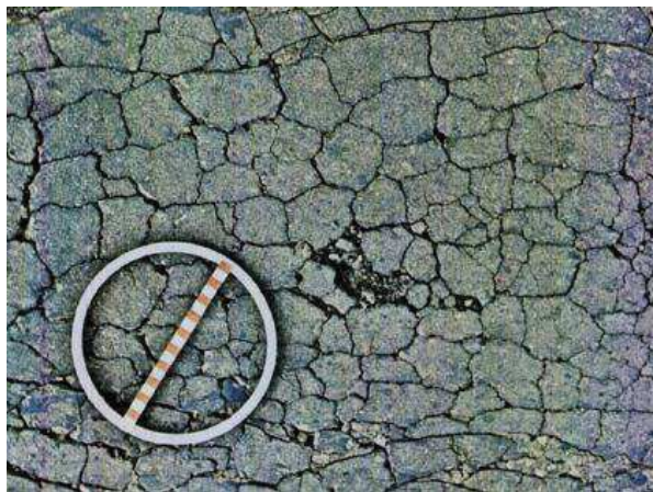
Figura 3 — Trinca interligada do tipo “couro de jacaré”.
