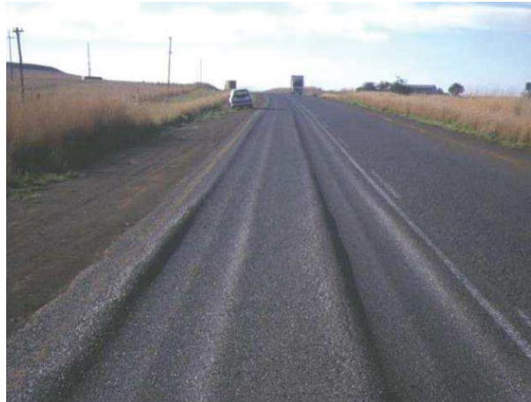
Figura 4 — Afundamento da trilha de roda.
