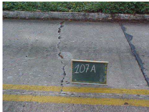
Figura 8 — Fissuras transversais no meio da placa.
