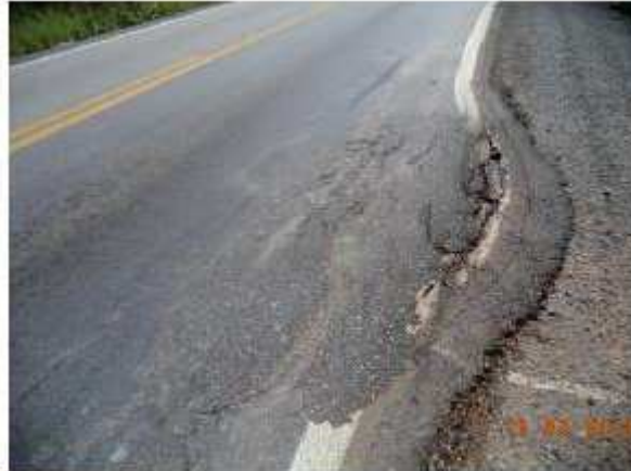
Figura 5 — Escorregamento do revestimento asfáltico.
