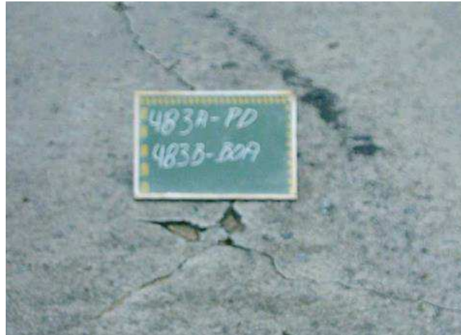
Figura 10 — Buracos na placa de concreto.
