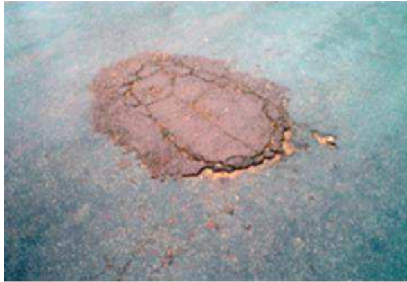
Figura 7 — Remendo mal executado.
