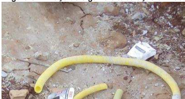
Figura 37 - Maço de cigarro e tubulação em local inadequado.
