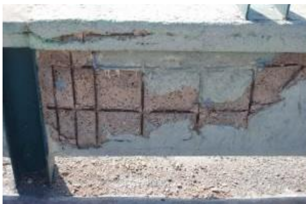
Figura 01 - Falha de concretagem (“bicheiras”) Fonte: Adaptado Repette, 2011.
