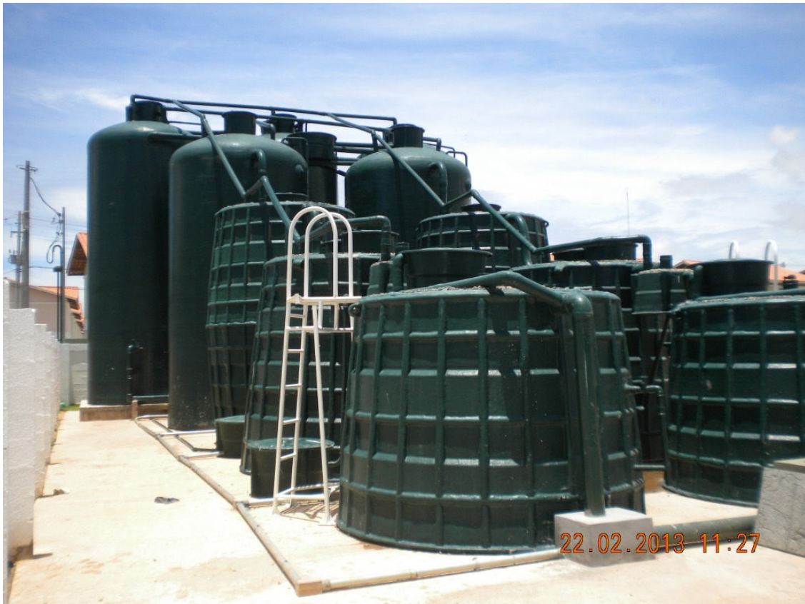
Figura 2 - ETE Compacta em Fibra. Conjunto Habitacional em Lauro de Freitas Fonte: Embasa, 2013.
