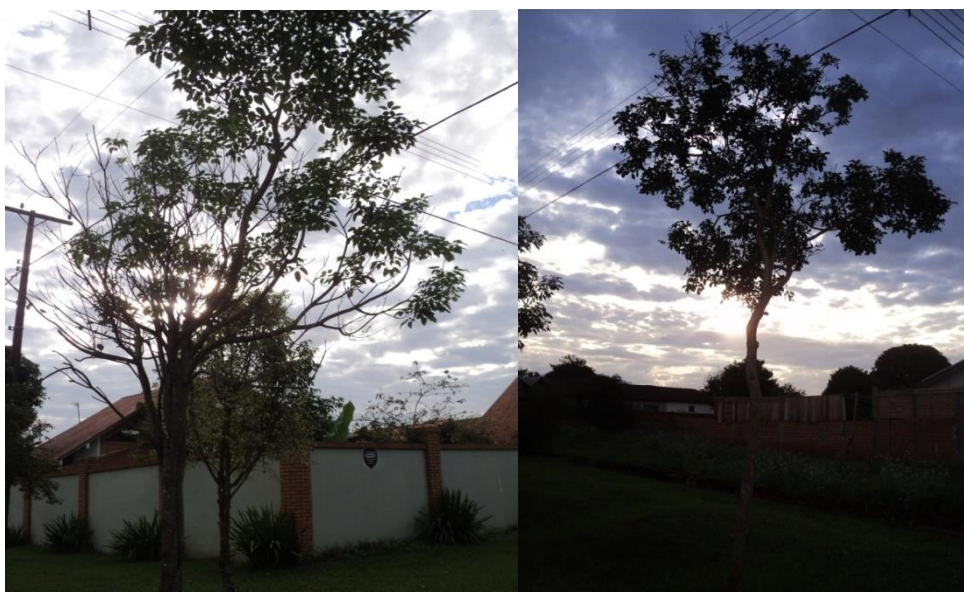
Figura 4 -Conflitos de indivíduos (copa) com a rede elétrica
