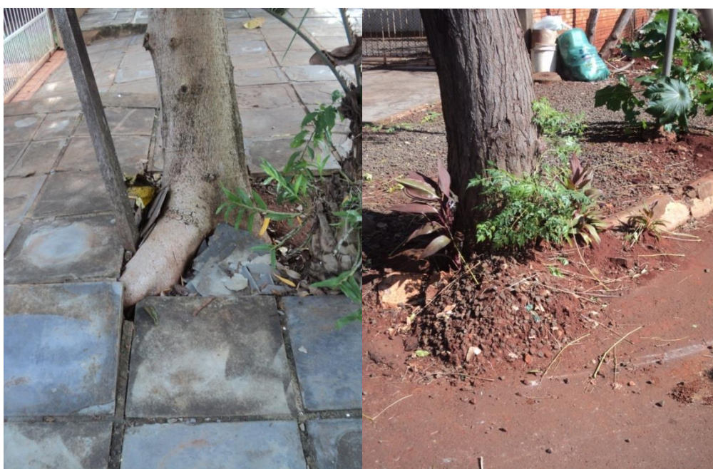
Figura 5 - Raízes danificando a estrutura da calçada e meio fio.
