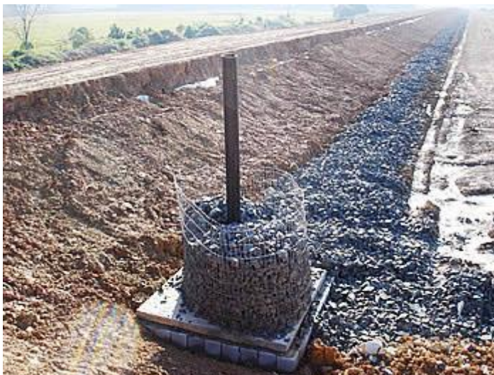
Figura 4 – Drenagem de gases
