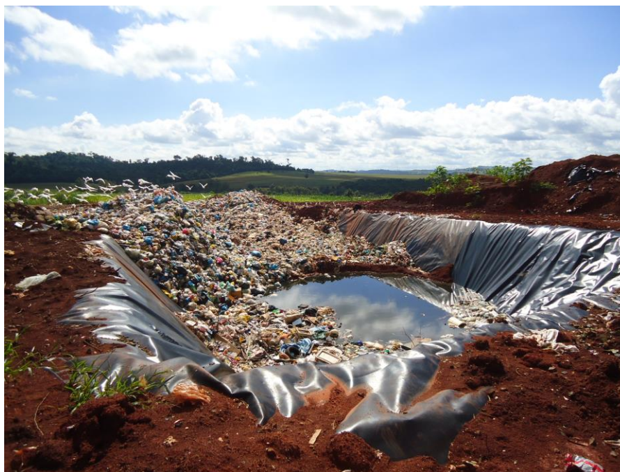
Figura 14 – Vala em operação no Aterro Controlado de São Miguel do Iguaçu.
