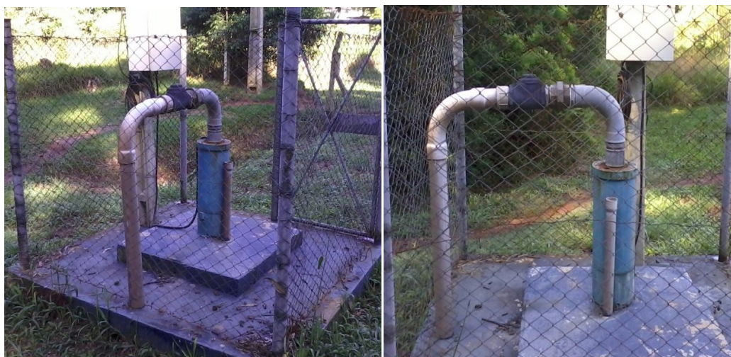
Figura 13 – Poço Tubular Profundo perfurado no município de Concórdia – SC.
