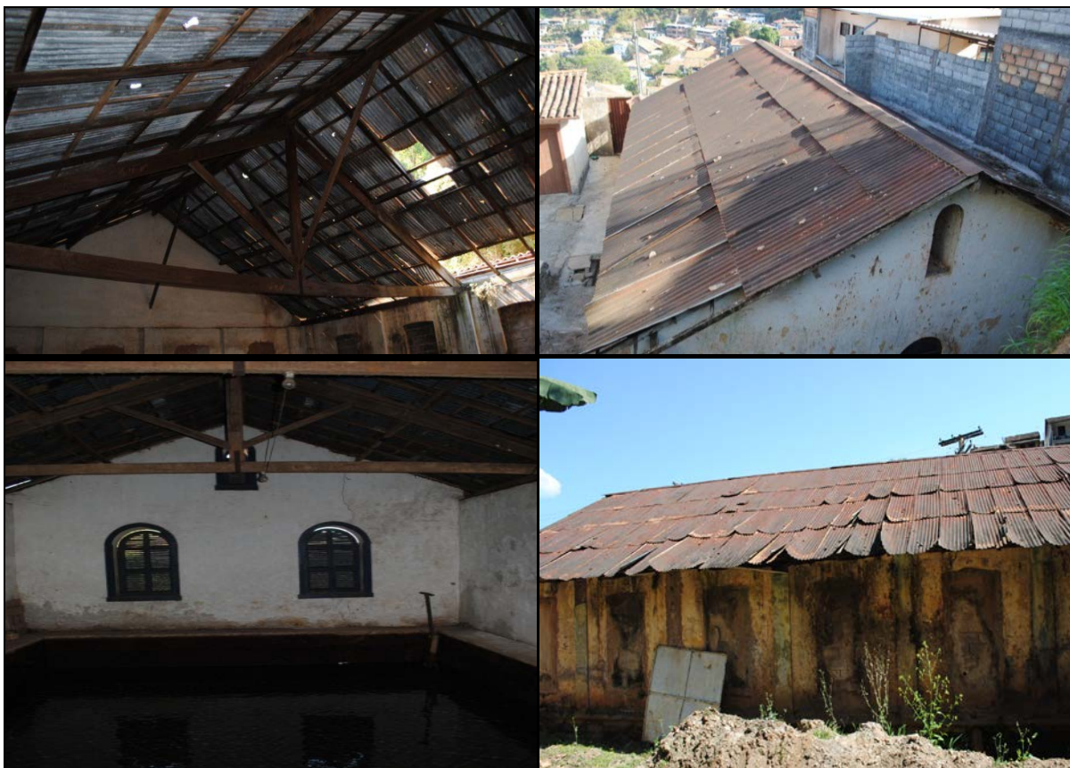
Figura 13 - Exemplos de reservatórios de água em mau estado de conservação Fonte: Galiani (2014)
