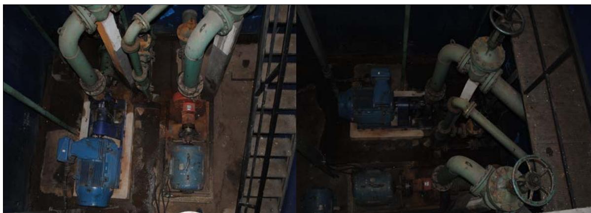
Figura 8 - Sistema de recalque da ETA Itacolomi Fonte: Galiani (2014)
