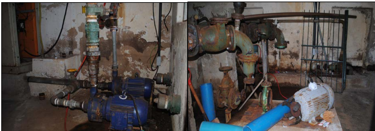
Figura 11 - Elevatórias do sistema de recalque de Ouro Preto
