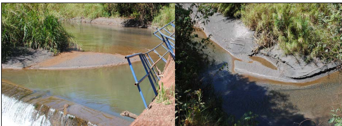
Figura 3 - Assoreamento das barragens de captação Fonte: Galiani (2014)
