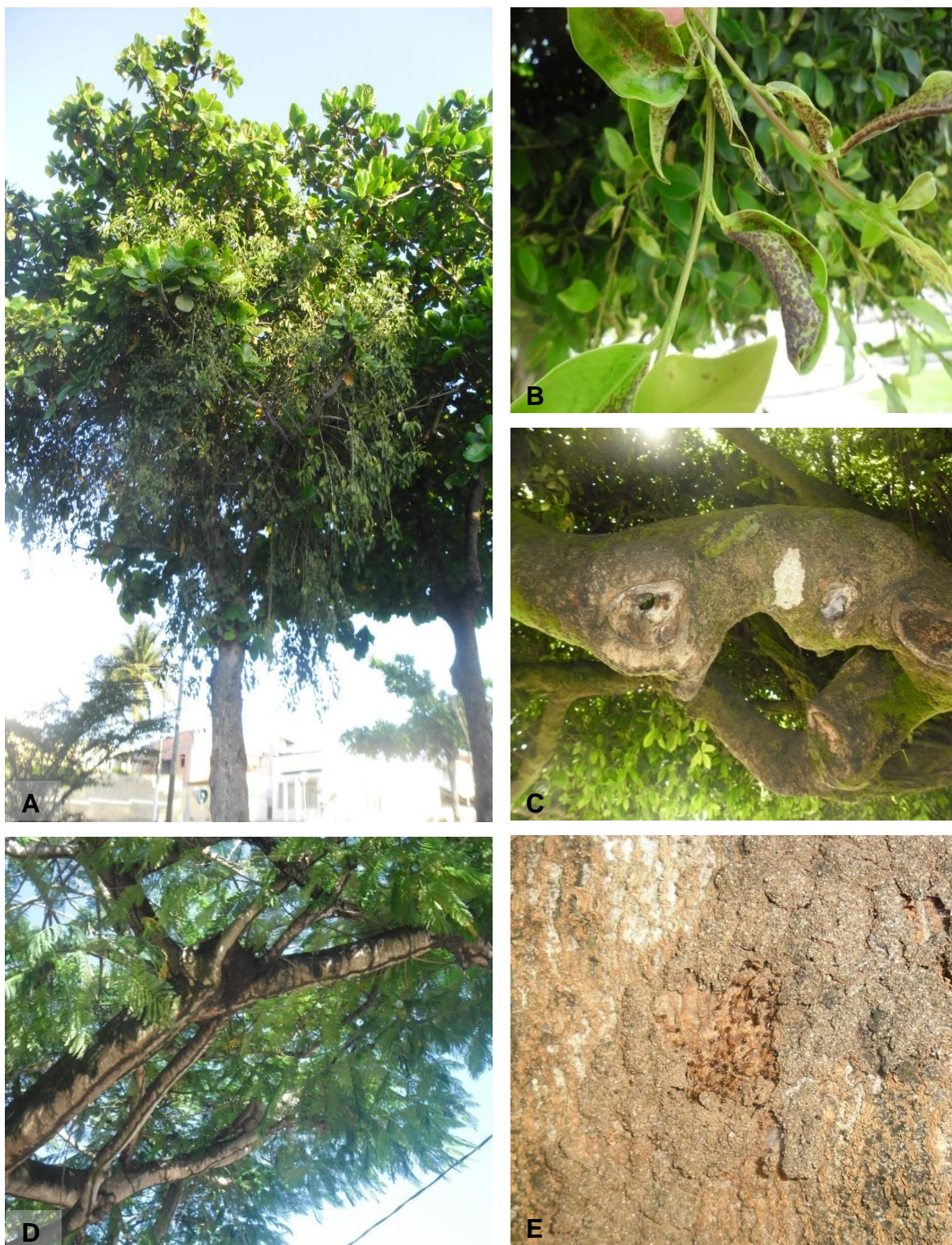
Figura 20- (A) Indivíduo Terminalia catappa Infestado de Erva de Passarinho; (B) Ficus com Folhas Atacadas por Lacerdinha; (C) Ficus com Tronco com Ocorrência de Poda Severa e Lesionado pela Ação de Insetos Broqueadores; (D e E) Ataque de Cupins em Delonix regia Fonte: Fotos do Autor, 2014.
