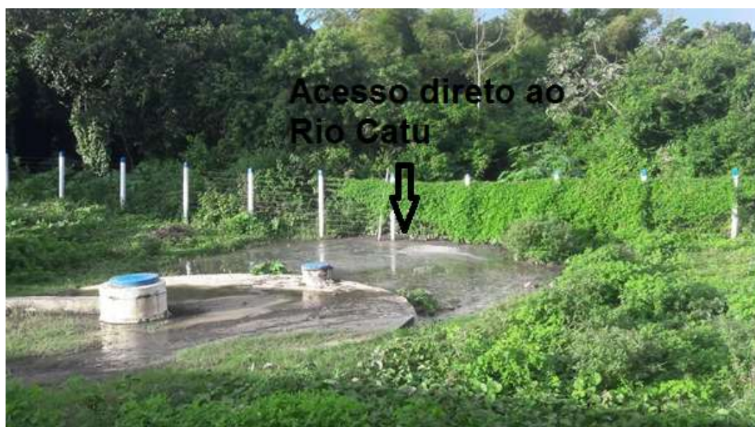
Figura 04: Esgoto Transbordando Lançado Diretamente no Rio Catu (ETE Loteamento Vila Dos Laranjais).
