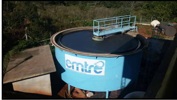
Figura 11: Decantador físico químico Fonte: AUTOR (2015)
