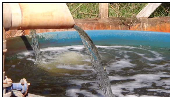
Figura 9: Chegada do efluente na empresa Fonte: AUTOR (2015)
