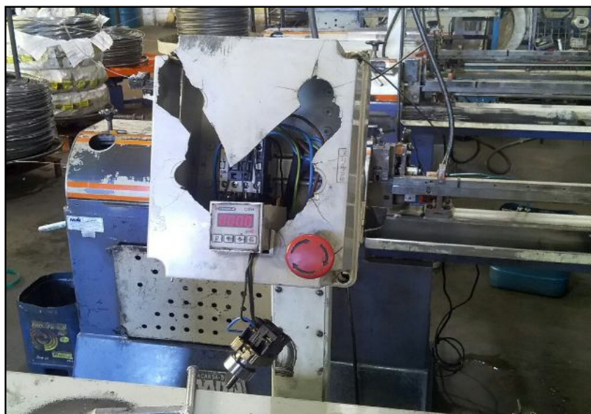
Figura 15 - Painel de comando da POL006
