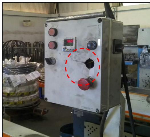
Figura 22 - Painel de comando da POL003.
