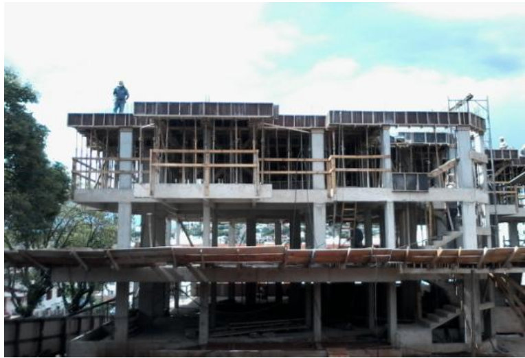
Figura 1 – Vista frontal da obra antes das medidas de segurança. Fonte: Autoria Própria.
