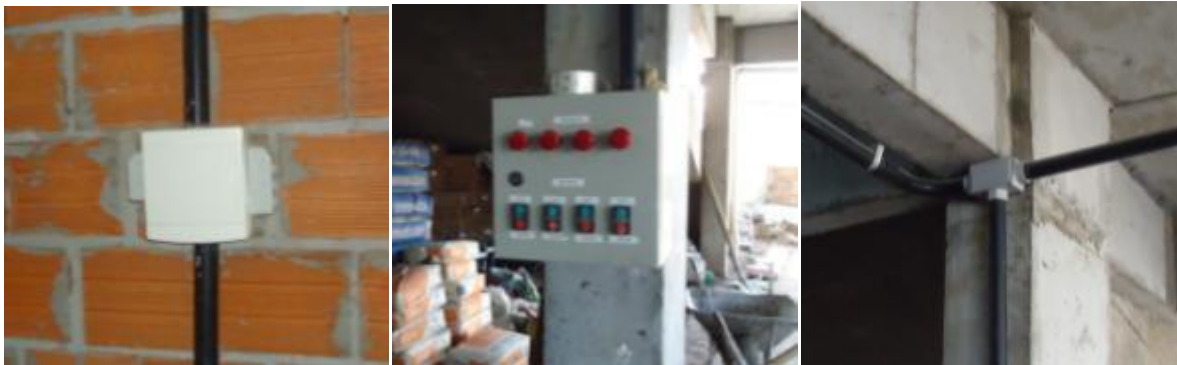
Figura 13 – Sistema elétrico depois. Fonte: Autoria Própria.
