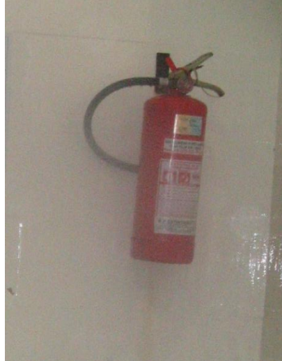
Figura 7 – Extintor da obra. Fonte: Autoria Própria.
