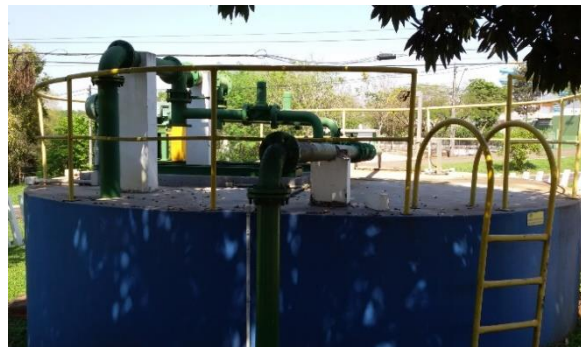
Tanque de Armazenamento de Água de Lavagem dos Filtros e bombas para recirculação da água de lavagem.
