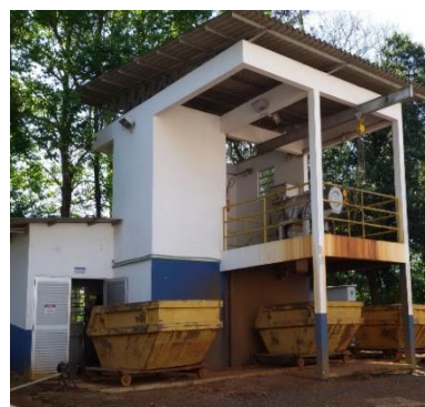
Centrífuga de Lodo e caçambas para recepção do lodo centrifugado
