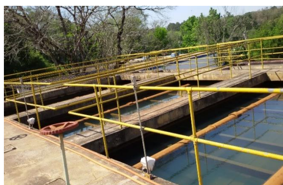
Decantadores (processo de sedimentação)
