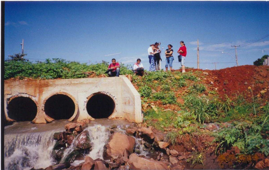
SAÍDA DO TRECHO MANILHADO, COMPLETAMENTO POLUÍDO E CONTAMINADO DETALHE À DIREITA - SAÍDA DE ESGOTO
