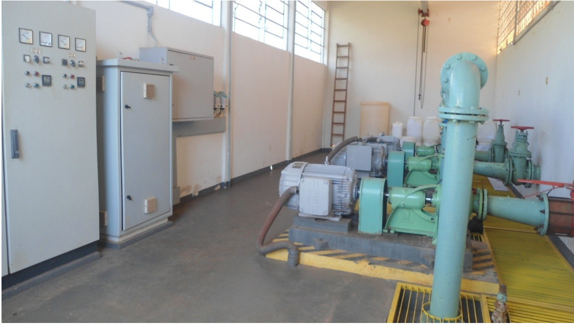
Figura 3. Casa das bombas Fonte: própria
