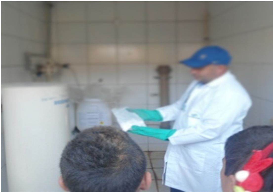
Figura 4. Sistema de tratamento Cloro, e flúor. Fonte: própria
