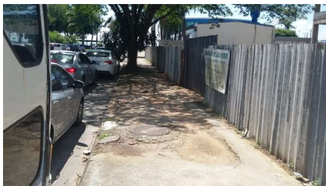
Figura 02 – Aquarius Life: Calçada degradada chama atenção na avenida Tubarão
