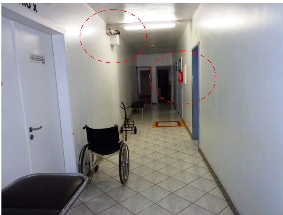
Fotografia 12 - Sistemas de Prevenção Contra Incêndio, Hospital Santa Mônica Fonte: Rocha, Cláudia. 2012.
