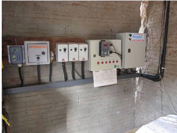
FIGURA 07 – Painel de comando do aviário.
