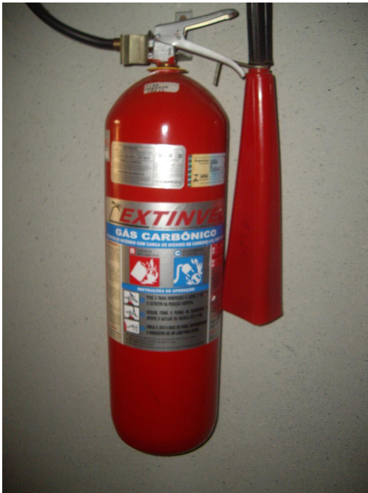
Figura 11 – Extintor de incêndio.
