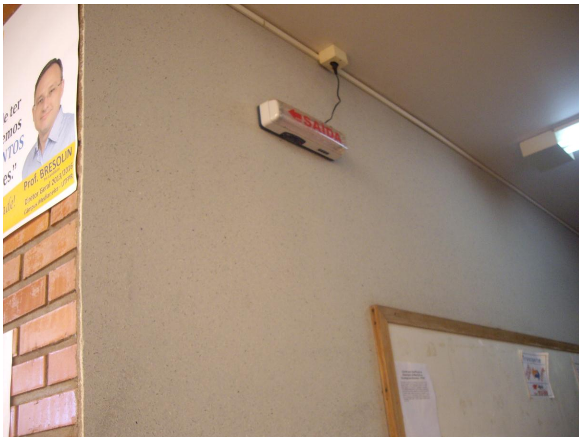
Figura 9 – Iluminação de saída de emergência.
