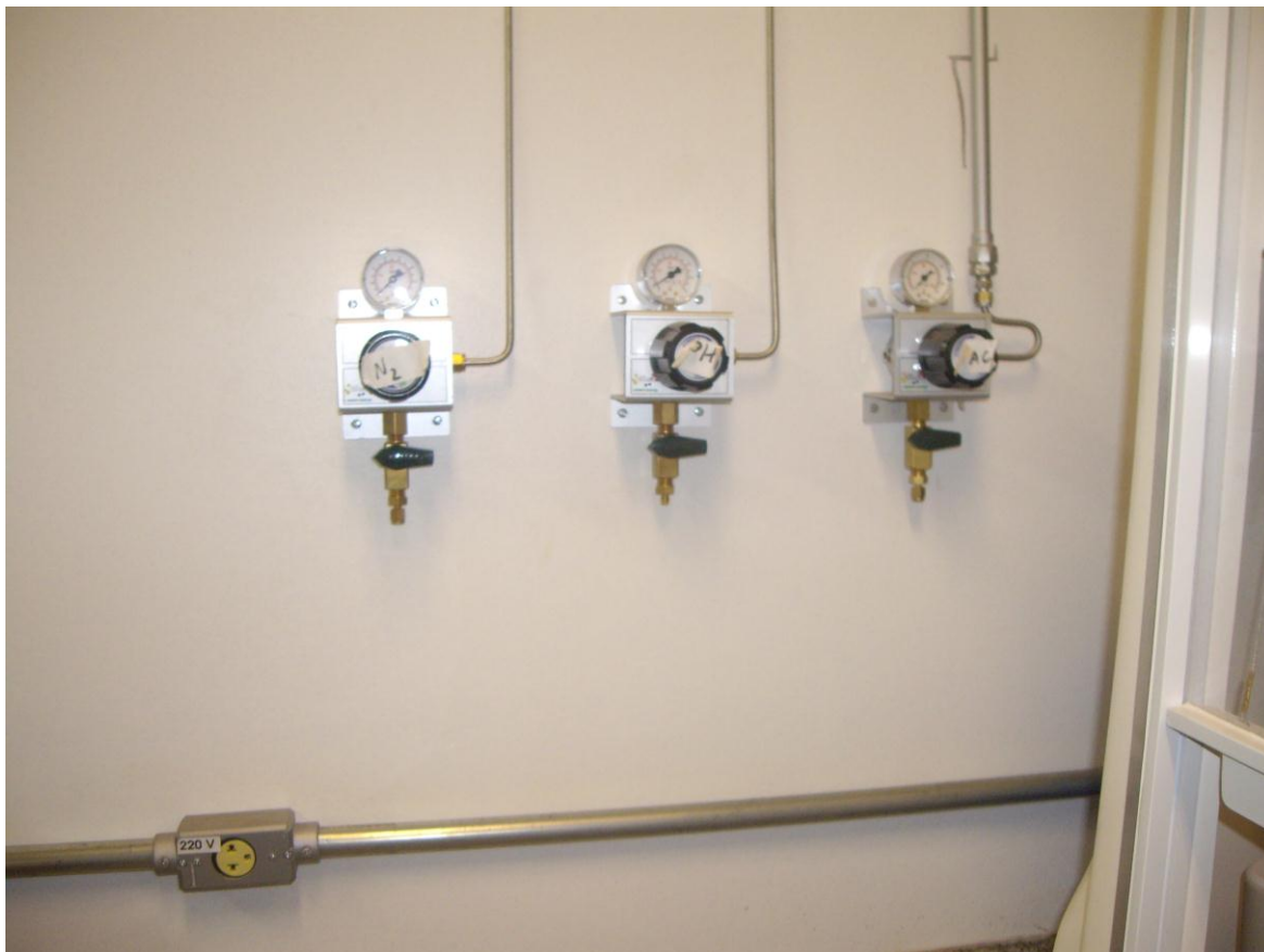
Figura 4 – Tubulação de gases.
