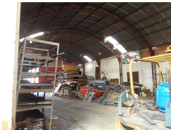
Fotografia 22 – Risco de Acidentes
