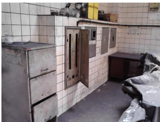
Fotografia 28 – Quadro de Energia
