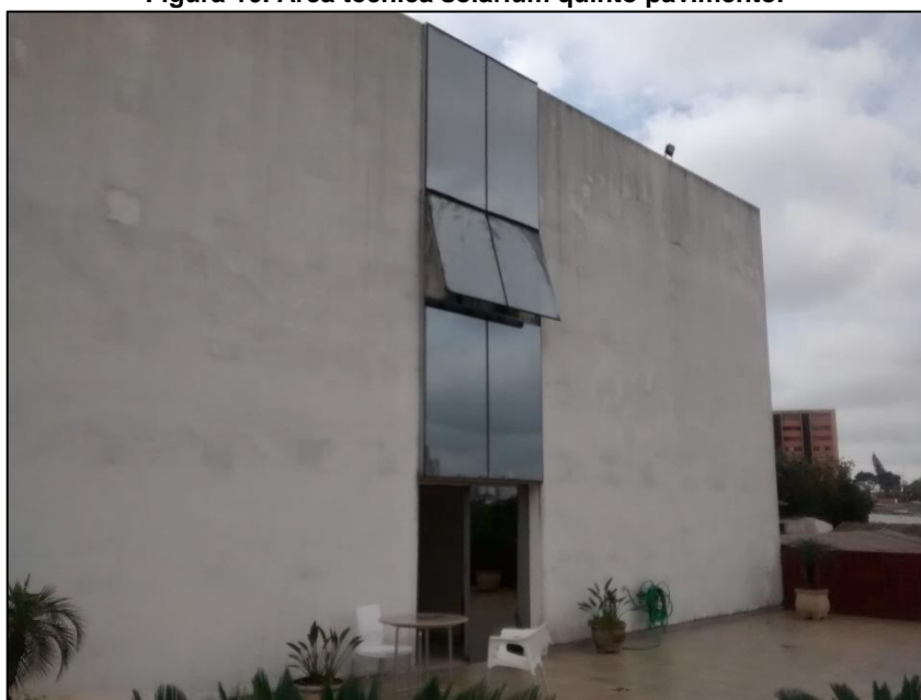
Figura 17. Vista da altura que o colaborador está exposto no quinto pavimento.
