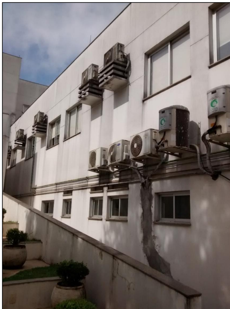
Figura 19. Acesso às máquinas de ar condicionado do terceiro e quarto pavimento.
