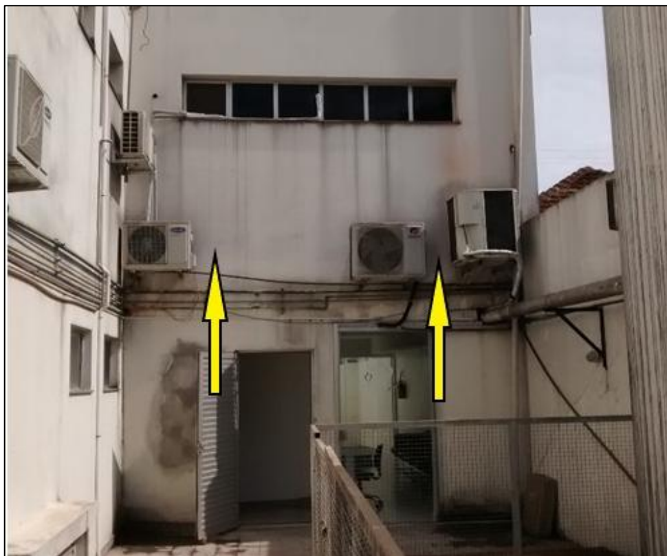
Figura 24. Máquinas de ar condicionado ao lado do setor hemodinâmica.
