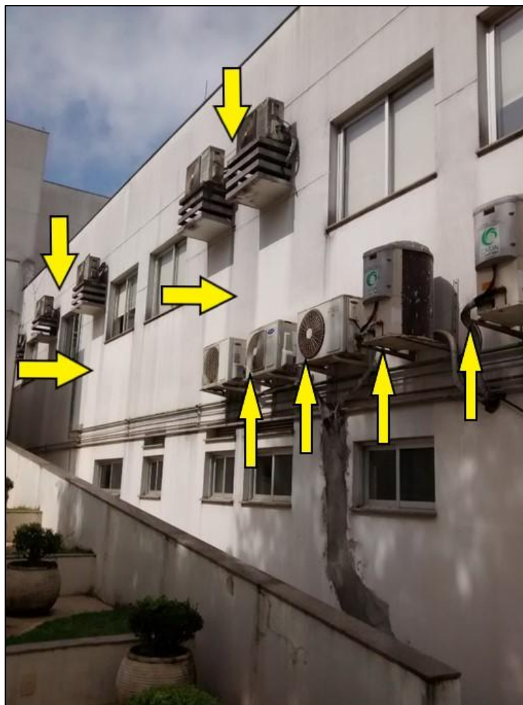
Figura 25. Pontos de ancoragem do terceiro e quarto pavimento ao lado da hemodinâmica.
