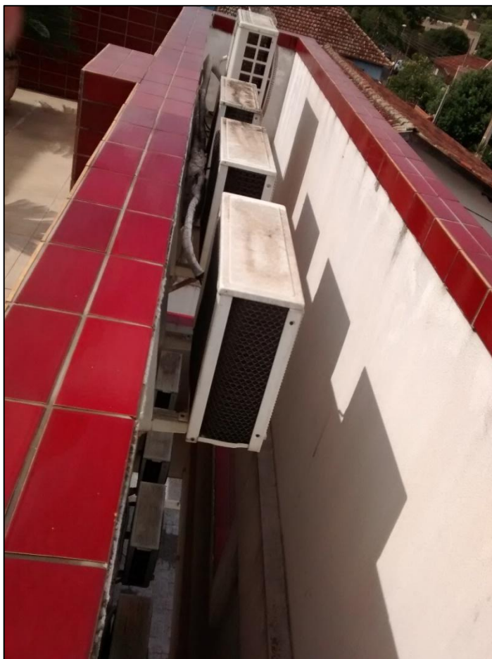
Figura 14. Local de posicionamento da escada para manutenção do ar condicionado.
