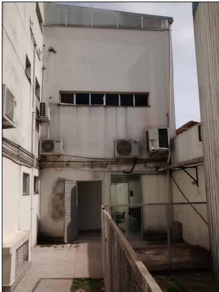
Figura 18. Localização de máquinas de ar condicionado atrás da Hemodinâmica.
