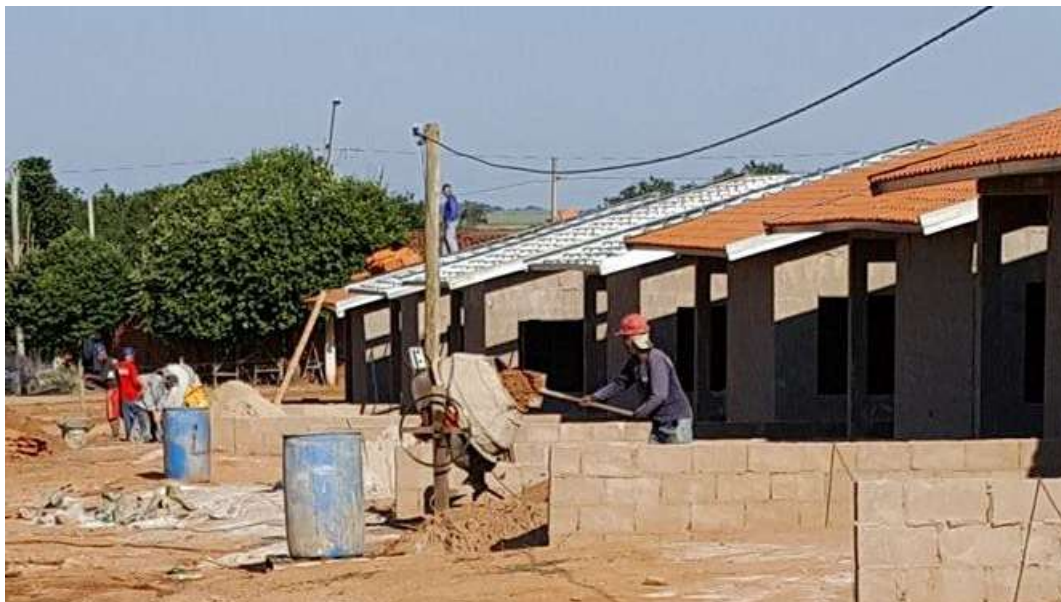
Fotografia 2 - Análise da etapa da preparação de massa para assentar blocos. Fonte: Autoria própria.
