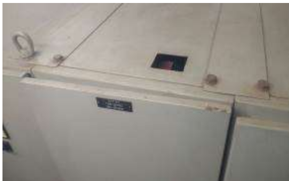
Fotografia 19 – Orifício na parte superior do painel Fonte: Autoria própria
