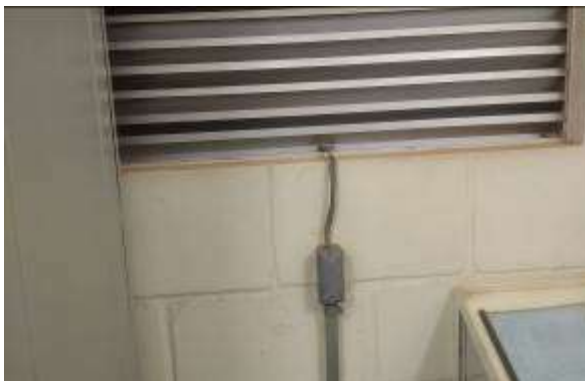
Fotografia 59 – Aterramento das partes metálicas. Fonte: Autoria própria
