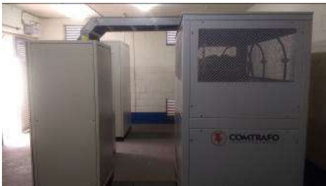
Fotografia 10 – Invólucro do transformador a seco
