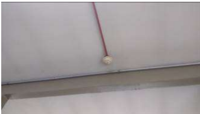
Fotografia 8 – Sistema de alarme de incêndio. Fonte: Autoria própria
