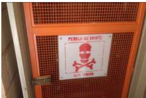
Fotografia 12 – Exemplos do painel e barreira impedindo acesso.
