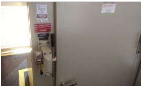
Fotografia 40– Exemplos de bloqueios e sinalizações das chaves seccionadoras Fonte: Autoria própria
