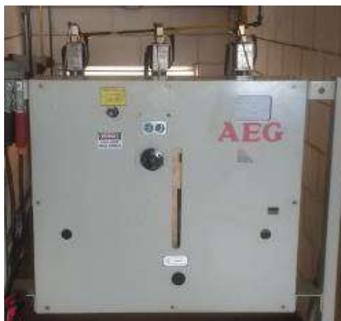
Fotografia 1 – Relé Primário Fonte: Autoria Própria
