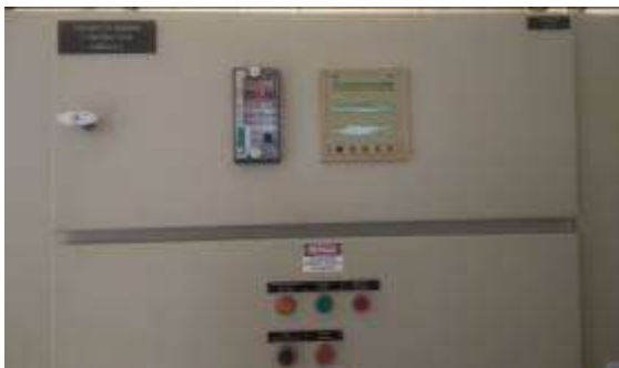
Fotografia 30 – Relés secundários com sinais de testes Fonte: Autoria própria
