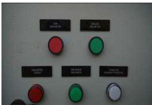
Fotografia 49 – Painel de Comando Remoto Fonte: Autoria própria
