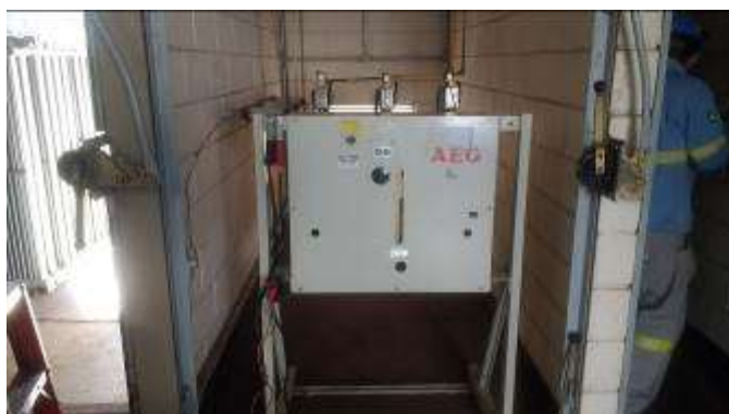
Fotografia 29 – Disjuntor com relé primário Fonte: Autoria própria
