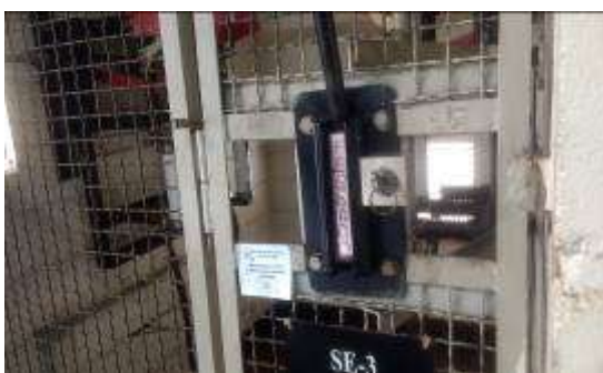
Fotografia 41 – Exemplos de bloqueios e sinalizações das chaves seccionadoras Fonte: Autoria própria
