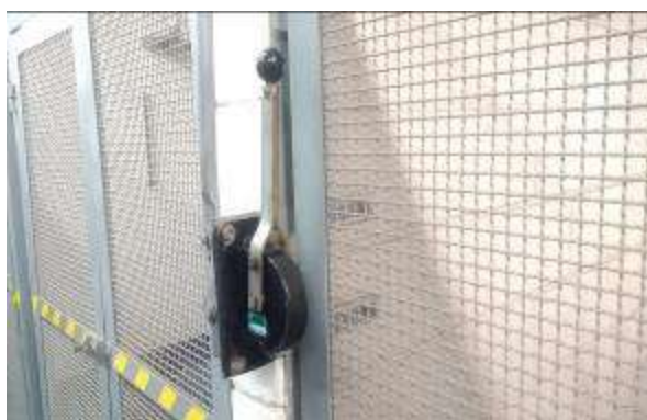
Fotografia 42 – Chave seccionadora sem sinalização e bloqueio Fonte: Autoria própria
