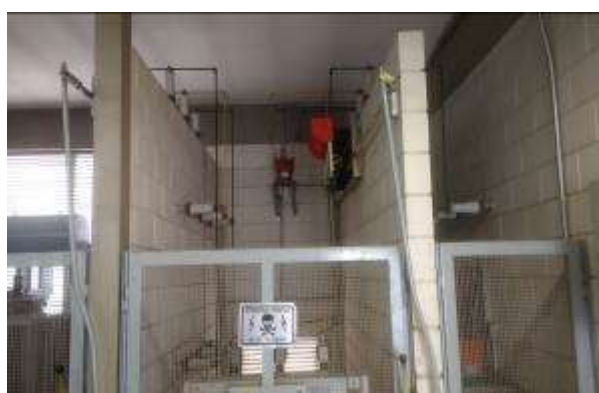
Fotografia 16 – Proteção parcial por colocação fora do alcance Fonte: Autoria própria
