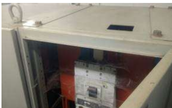
Fotografia 20 – Orifício na parte superior do painel Fonte: Autoria própria
