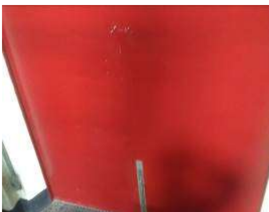
Fotografia 25 – Porta corta fogo - verso Fonte: Autoria própria
