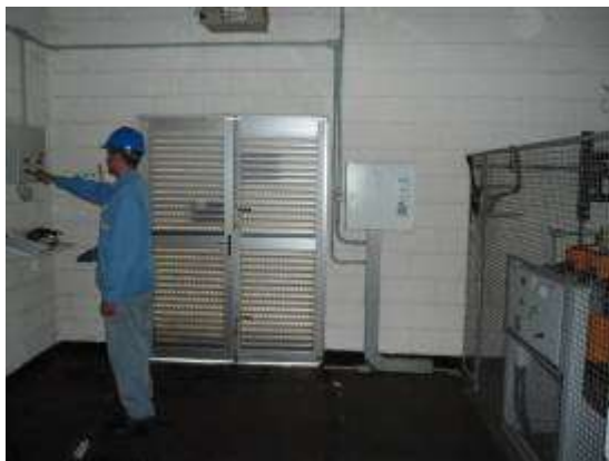
Fotografia 50 – Comando Remoto em frente ao disjuntor Fonte: Autoria própria
