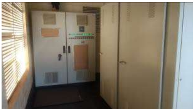
Fotografia 24 – Orifício fechado com papelão Fonte: Autoria própria
