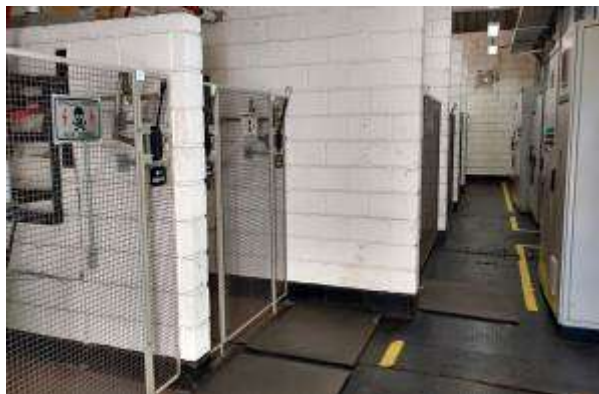
Fotografia 15 – Proteção parcial por colocação fora do alcance Fonte: Autoria própria
