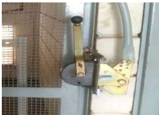
Fotografia 43 – Chave seccionadora sem sinalização e bloqueio com pino Fonte: Autoria própria
