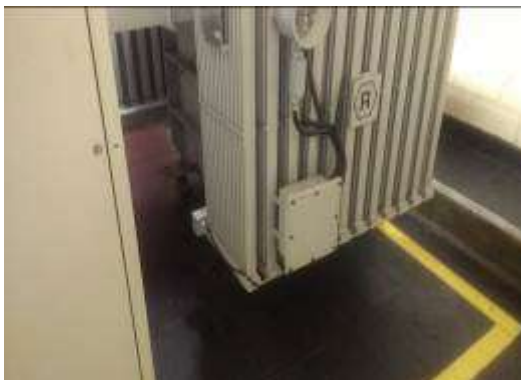
Fotografia 36 – Caixas de contenção de óleo do transformador Fonte: Autoria própria
