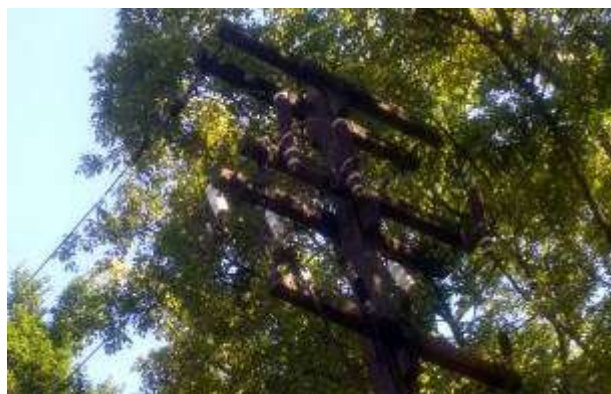
Fotografia 63 – Para-raios de Cerâmica Fonte: Autoria própria
