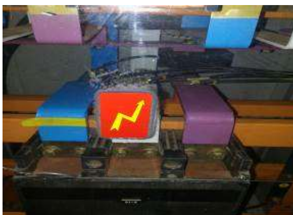
Fotografia 14 – Exemplos do painel e barreira impedindo acesso. Fonte: Autoria própria
