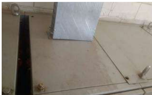
Fotografia 21– Orifício dando acesso aos polos do disjuntor Fonte: Autoria própria
