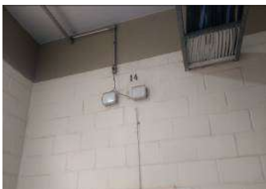
Fotografia 7 – Exemplo de iluminação de emergência Fonte: Autoria própria
