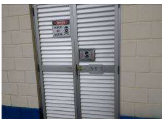
Fotografia 26 – Porta Metálica Fonte: Autoria própria
