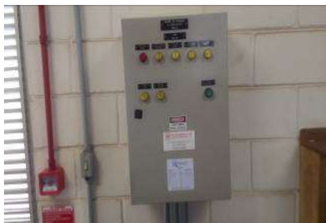
Fotografia 9 – Alarme de incêndio em alguns pontos da indústria. Fonte: Autoria própria
