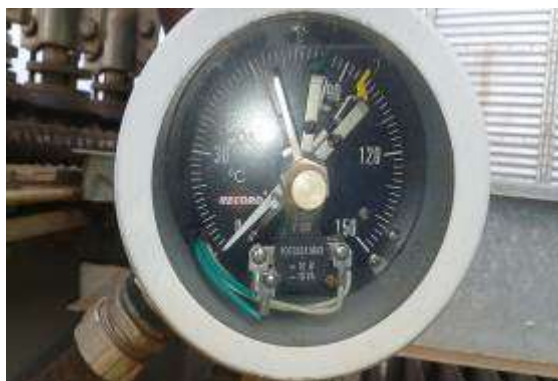
Fotografia 32 – Medidor de temperatura transformadores a óleo
