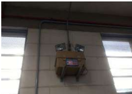
Fotografia. 6– Exemplo de iluminação de emergência Fonte: Autoria própria
