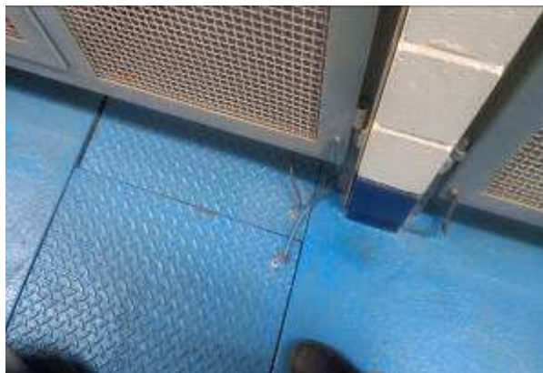
Fotografia 62 – Aterramento das partes metálicas. Fonte: Autoria própria
