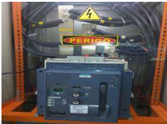
Fotografia 13 – Exemplos do painel e barreira impedindo acesso. Fonte: Autoria própria
