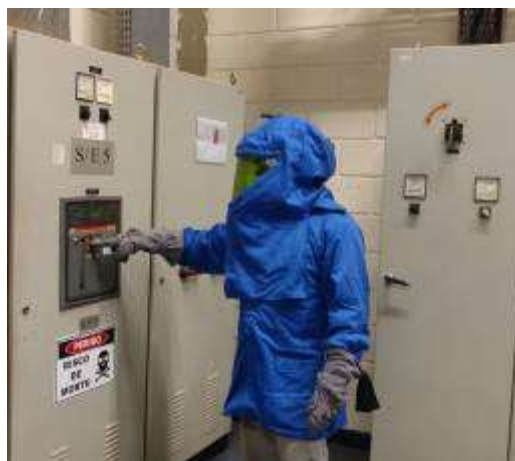
Fotografia 47 – Manobra do disjuntor Fonte: Autoria própria
