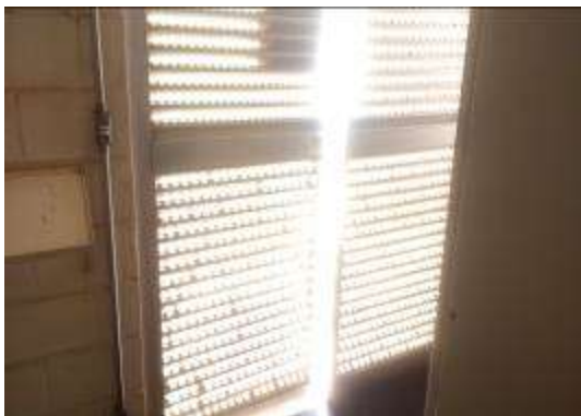
Fotografia 27 – Porta Metálica Fonte: Autoria própria
