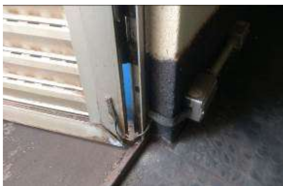
Fotografia 60 – Aterramento das partes metálicas. Fonte: Autoria própria
