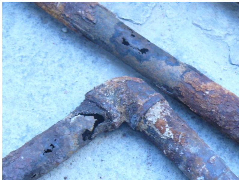
Figura 9 – Vista de tubulação de ferro corroída
