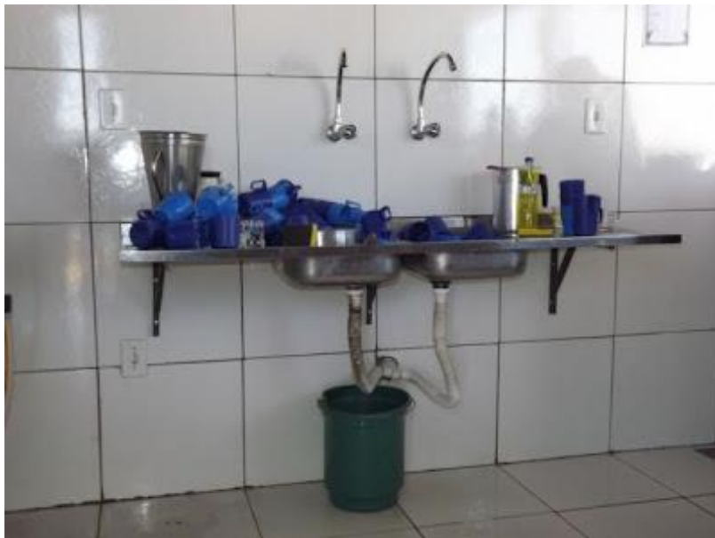
Figura 2 – Saída inadequada de esgoto
