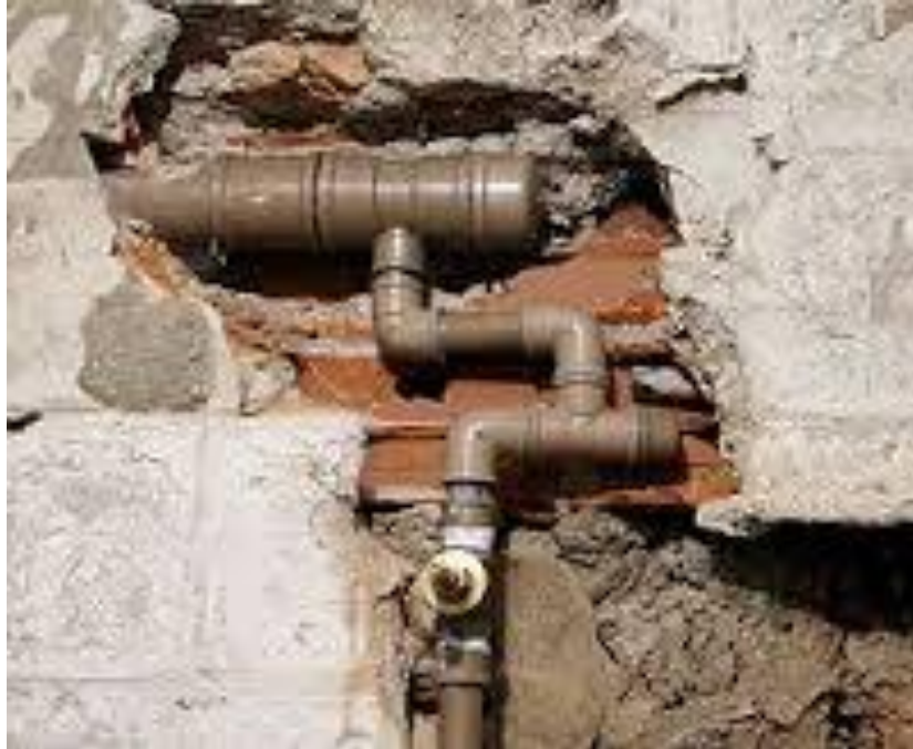
Figura 8 – Execução inadequada de tubulações
