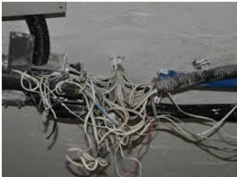
Figura 20 – Conduitos de baixa qualidade
