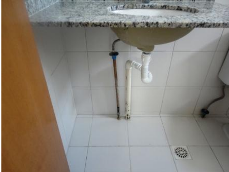
Figura 1 – Saída inadequada de esgoto
