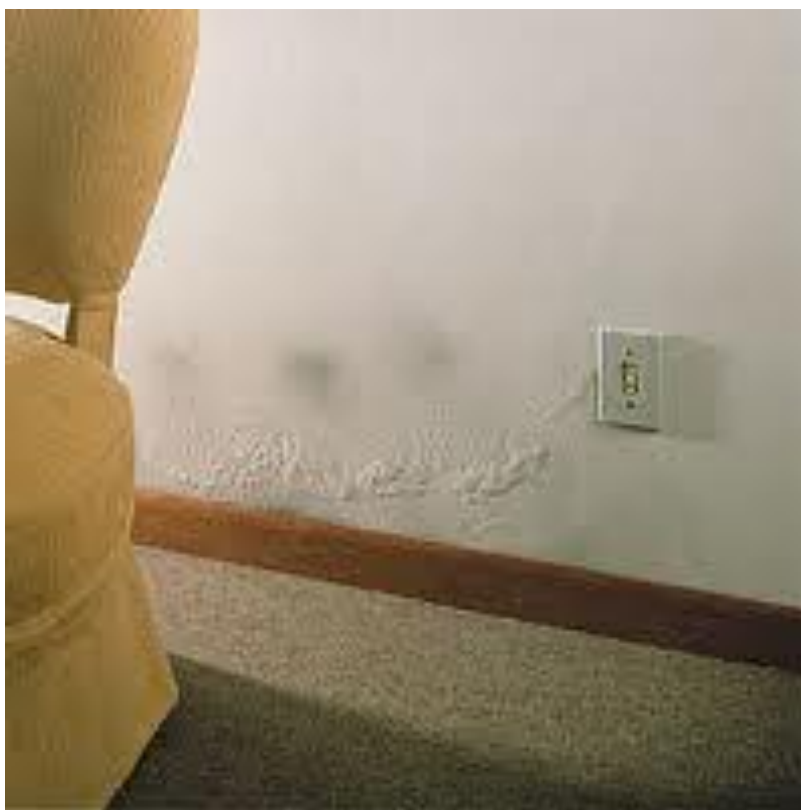
Figura 11 – Infiltrações em alvenarias
