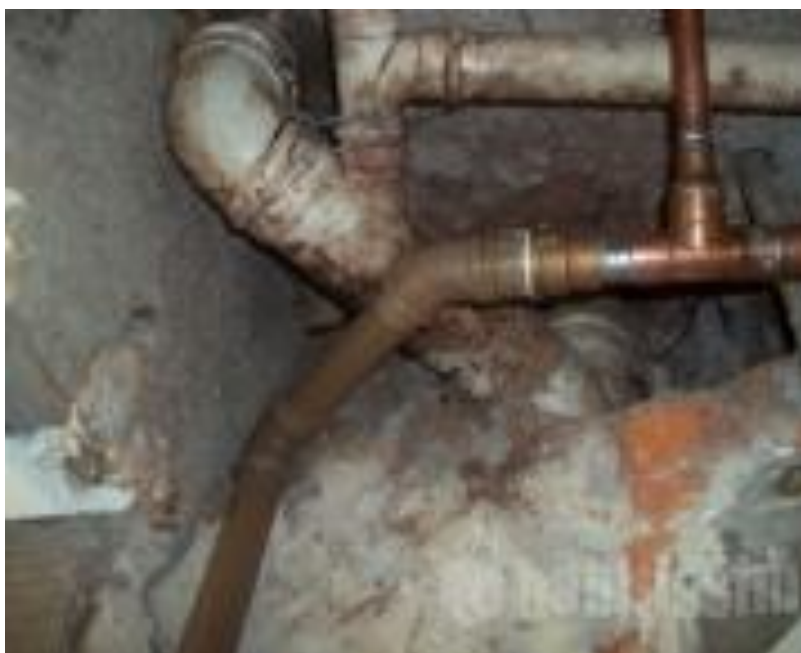
Figura 7 – Execução inadequada de tubulações
