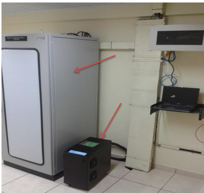
Figura 16 – Sala de Painéis (depois) com Painel Integrador SCD CDE e Inversor
