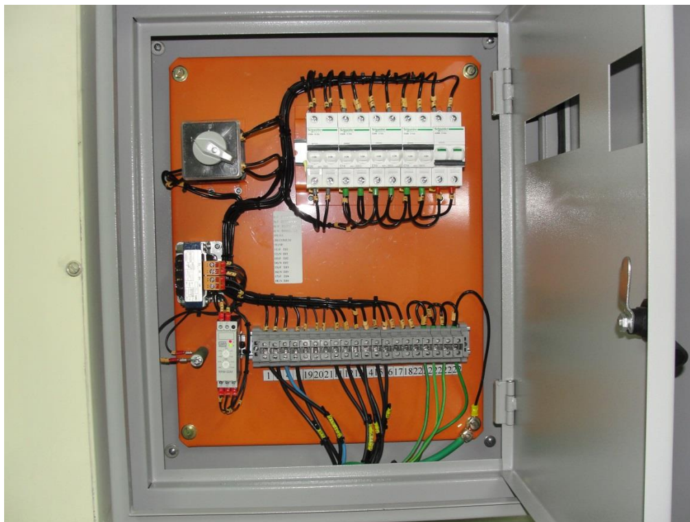
Figura 13 – Quadro de Distribuição de Corrente Alternada (QDCA)
