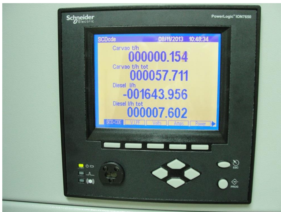
Figura 10 – Medidor Integrador (frente).
