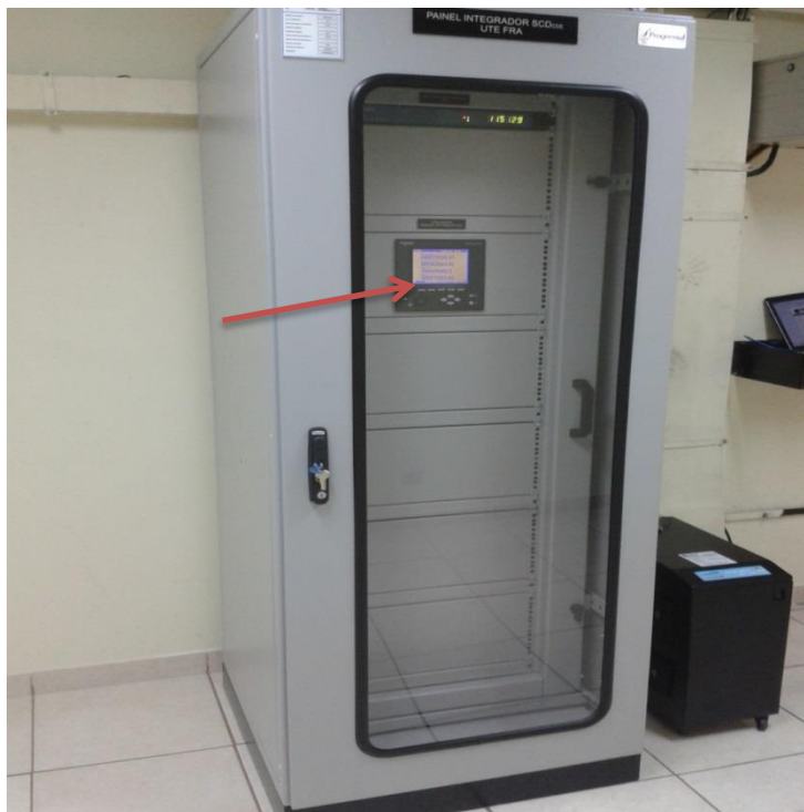
Figura 17 – Painel Integrador SCD CDE com Medidor Integrador
