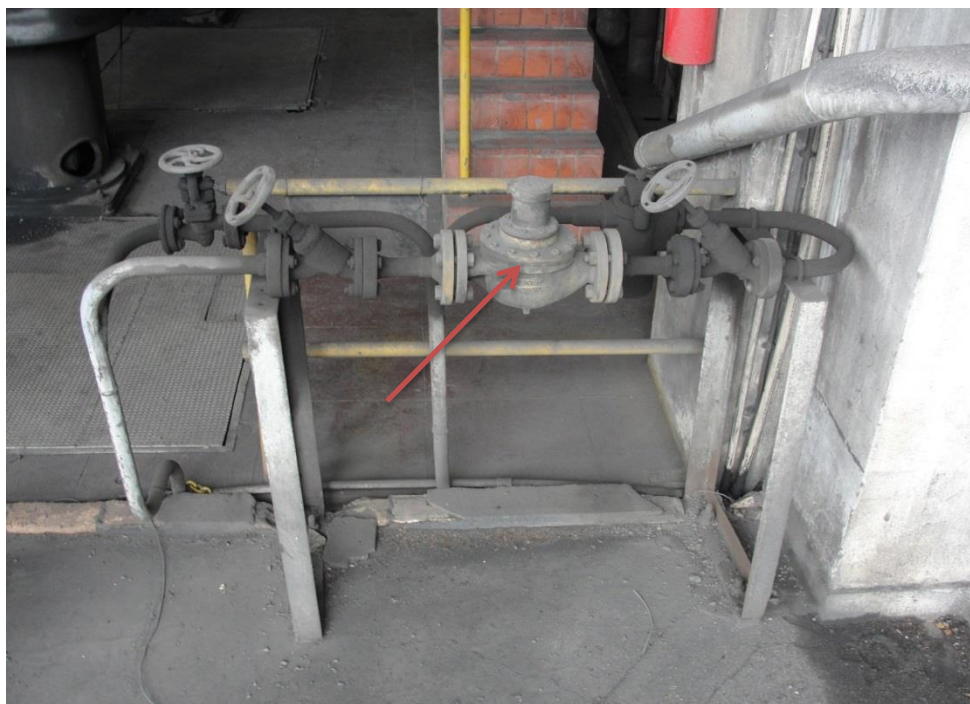
Figura 7 – Sistema de medição do Diesel ( antes), sem comunicação de dados.
