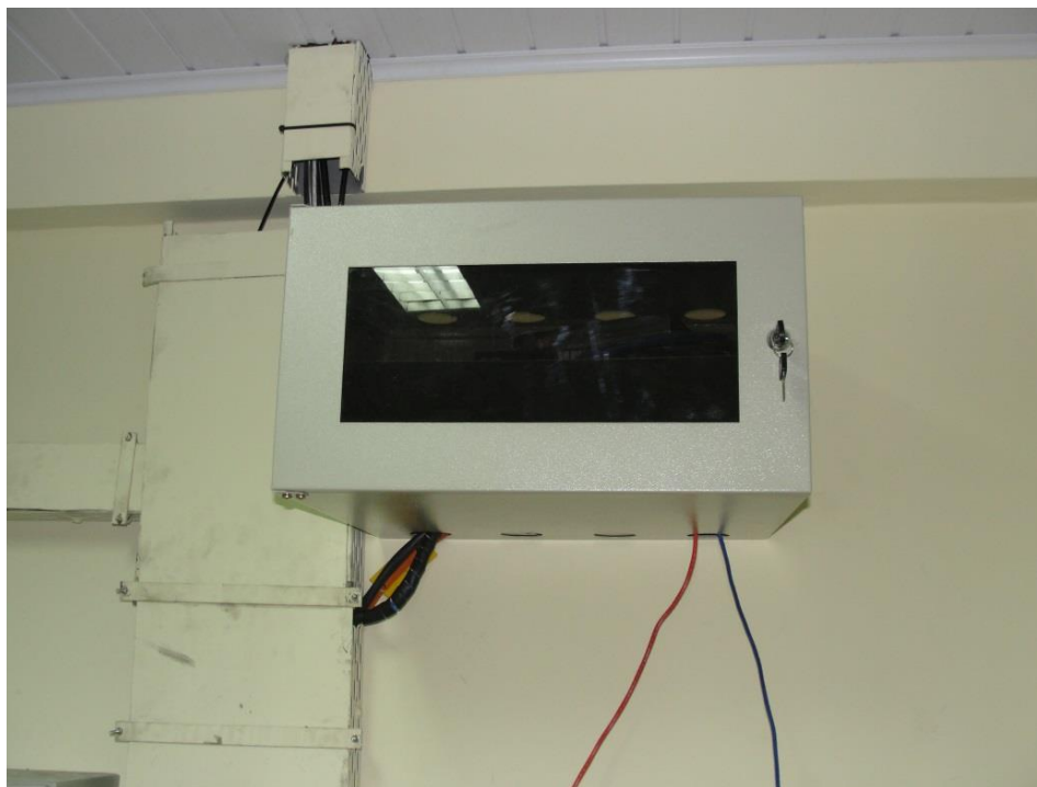
Figura 14 – Quadro Distribuidor Óptico com modem para a interface Telecom.
