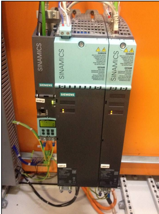
Figura 08: Drive de Potência com CPU e Módulo de Controle.
