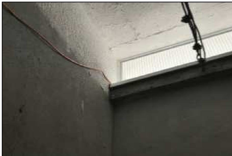
Figura 21- Cabo SPDA encostando em metal de grade Fonte: Laudo de Inspeção Predial- Empresa X (2015)
