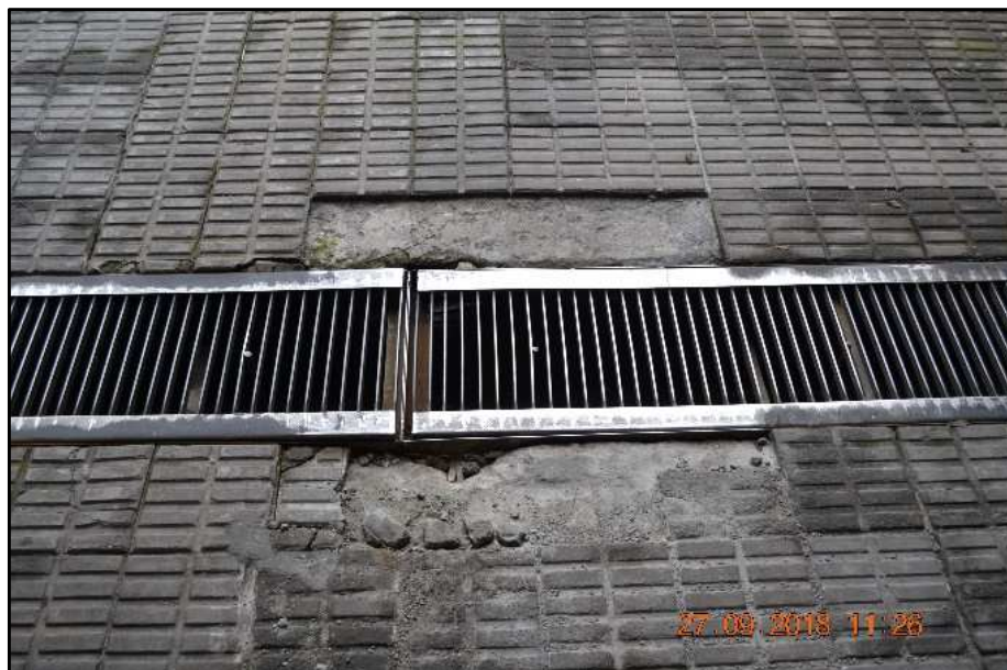
Figura 14- Soltura de peças de revestimento de rampa de acesso ao subsolo Fonte: Laudo de Inspeção Predial- Empresa X (2018)
