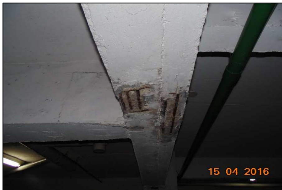
Figura 10- Armaduras aparentes em vigas Fonte: Laudo de Inspeção Predial- Empresa X (2016)
