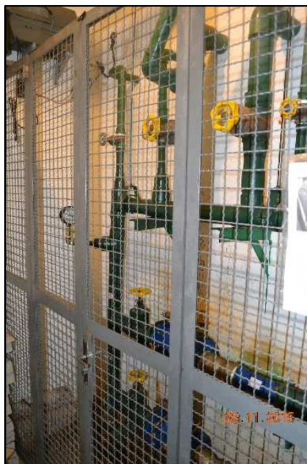
Figura 17- Válvulas redutoras de pressão no subsolo de um dos Edifícios analisados Fonte: Laudo de Inspeção Predial- Empresa X (2016)
