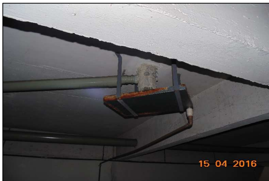
Figura 16- Falhas de impermeabilização em subsolo Fonte: Laudo de Inspeção Predial- Empresa X (2016)
