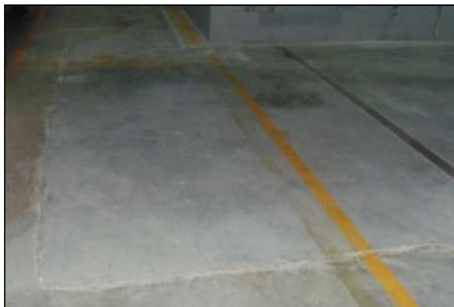
Figura 12- Desagregação de piso de concreto em subsolo Fonte: Laudo de Inspeção Predial- Empresa X (2017)
