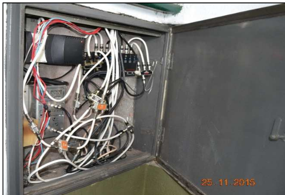
Figura 19- Quadro elétrico Fonte: Laudo de Inspeção Predial- Empresa X (2015)
