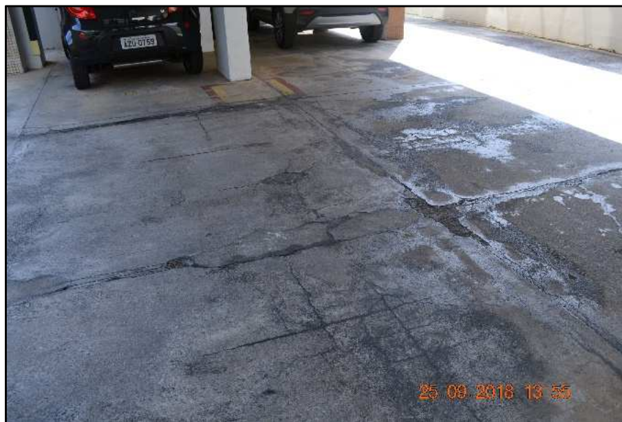
Figura 13- Desagregação de piso em vagas de estacionamento Fonte: Laudo de Inspeção Predial- Empresa X (2018)
