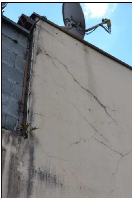
Figura 15- Fissuração em edifício Fonte: Laudo de Inspeção Predial- Empresa X (2018)
