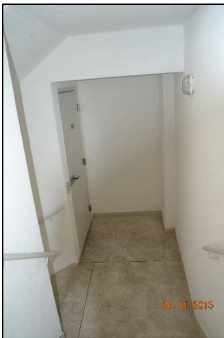
Figura 20- Escadaria sem sinalização de rota de fuga Fonte: Laudo de Inspeção Predial- Empresa X (2015)
