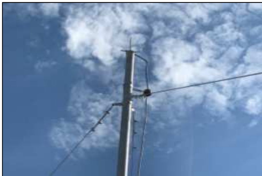
Figura 22- Porcas dos para-raios enferrujadas Fonte: Laudo de Inspeção Predial- Empresa X (2018)
