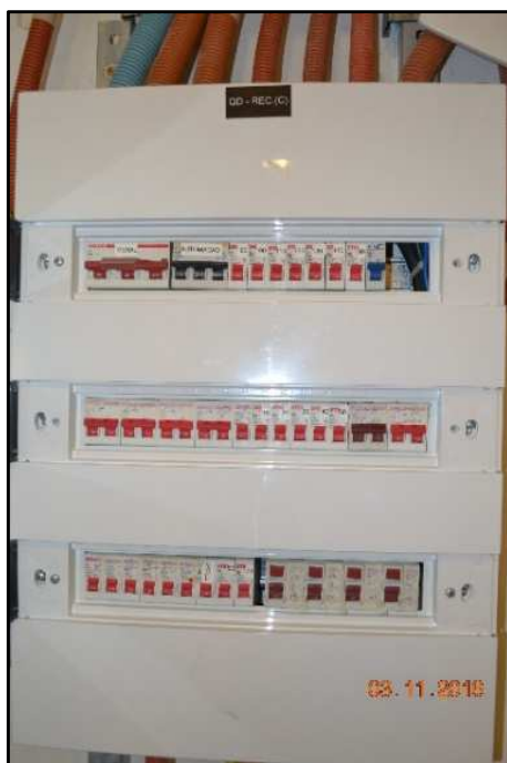
Figura 18- Quadro elétrico sem identificação Fonte: Laudo de Inspeção Predial- Empresa X (2018)
