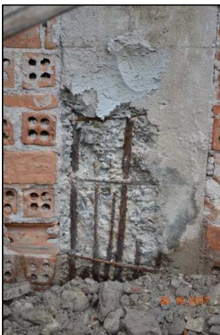
Figura 09- Armaduras aparentes em pilar Fonte: Laudo de Inspeção Predial- Empresa X (2016)
