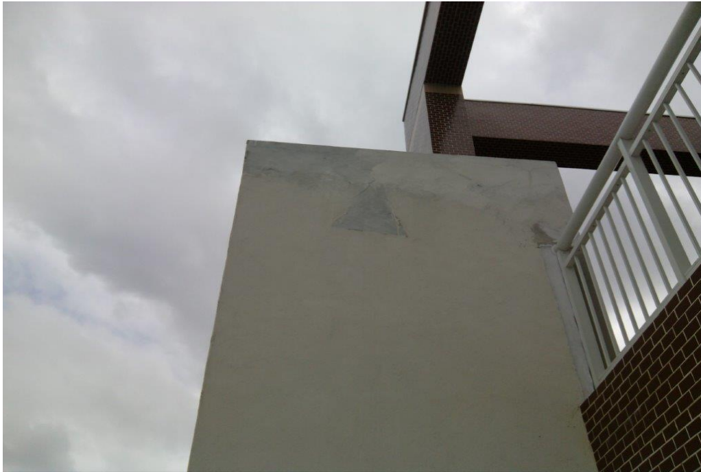
Figura 18: Cobertura com falhas de pintura, por conta da ancoragem do balancim. (Fonte: empresa estudada).
