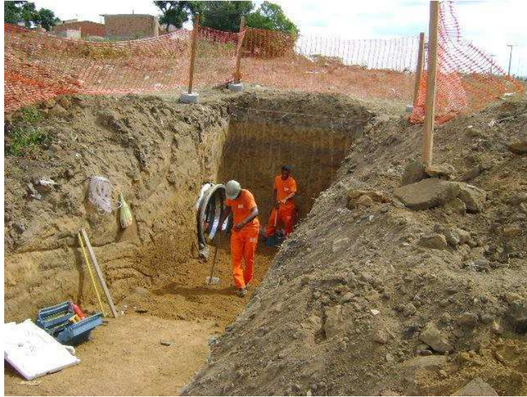
Figura 17 - Emboque do túnel diretamente no talude Fonte: Fortes (2010)
