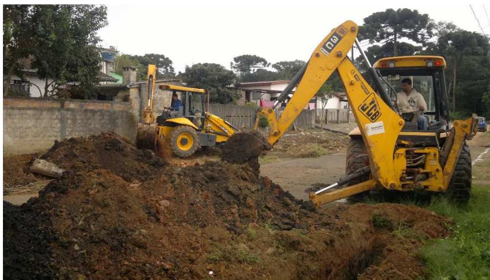
Figura 3 - Abertura de valas para execução de rede coletora de esgoto Fonte: Construferris (2016)
