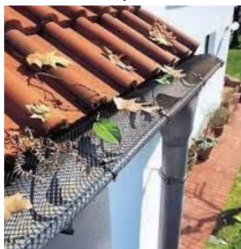
Figura 16- Calha com a tela de proteção Fonte: (ADESULCALHAS, 2016)
