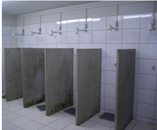
Figura 5: Banheiros com chuveiro elétrico da fábrica Fonte: O autor
