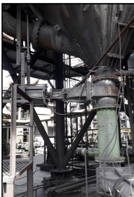
Figura 4.9 – Válvula de descarga de emergência do Venturi Scrubber 1 (VS1)
