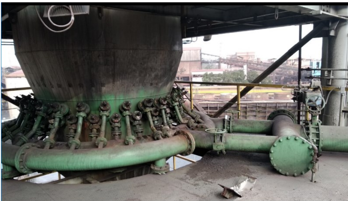
Figura 4.8 – Válvula de controle de vazão de água dos bicos spray do Venturi Scrubber 1 (VS1)
