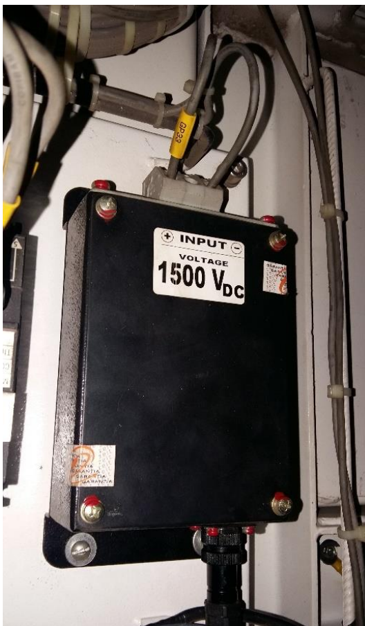
Fotografia 4.3 – Transdutor de tensão
