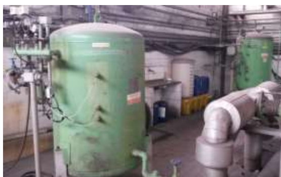
Fotografia 4.2 – Tanques de expansão de água gelada.
