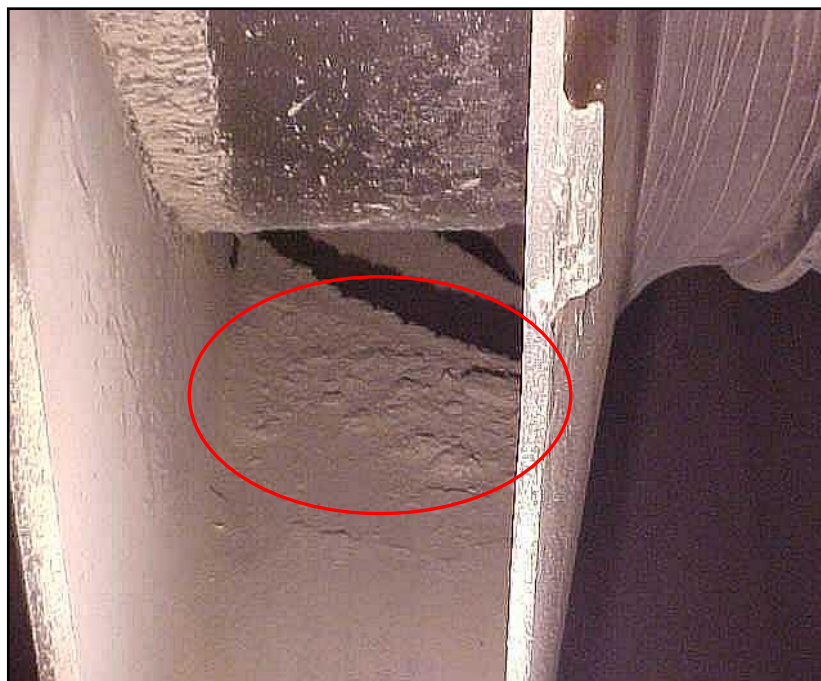
Foto 3 – Material acumulado nas aletas do rotor do exaustor Fonte: Autoria própria.
