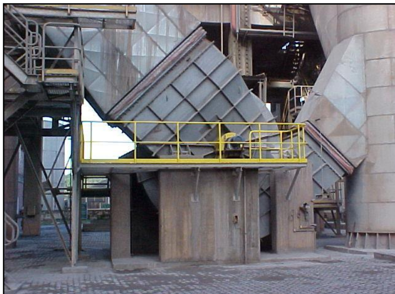
Foto 1 – Exaustor de forno de fábrica de cimento Fonte: Autoria própria.
