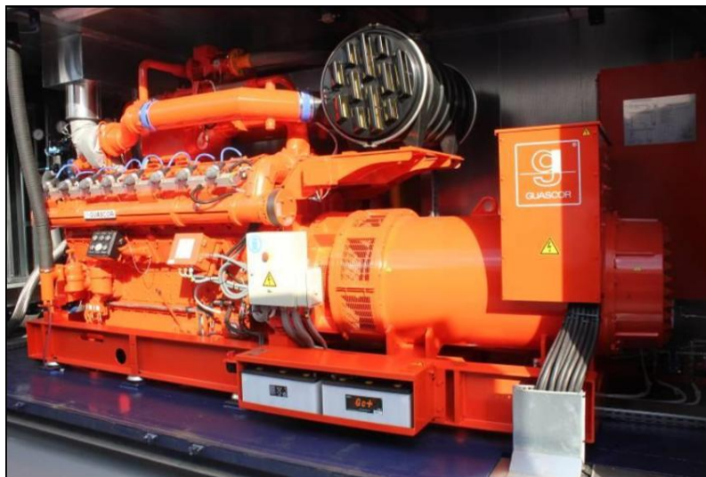
Figura 28 – Grupo gerador ciclo Otto ETE Ribeirão Preto.
