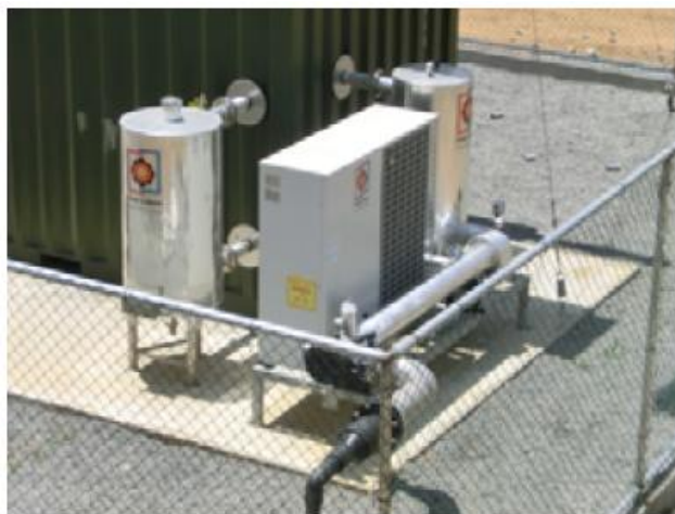
Figura 22 – Tratamento complementar c/ refrigerador e filtro de carvão ativado
