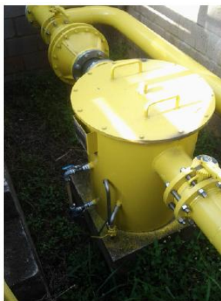
Figura 23 – Filtro de sedimentos com dreno para condensado
