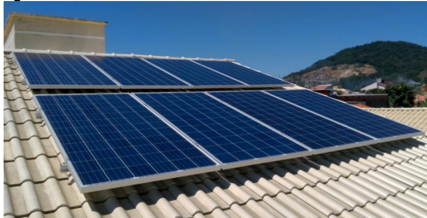
Figura 1 - Sistema fotovoltaico instalado em cobertura residencial.
