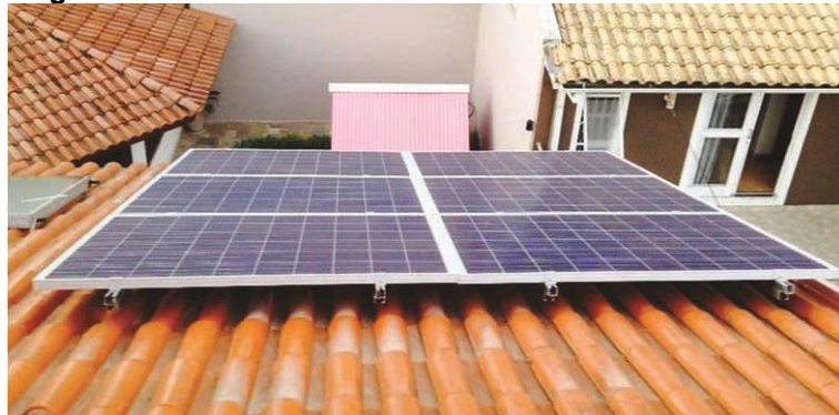
Figura 25 - Vista dos módulos fotovoltaicos no residencial 2
