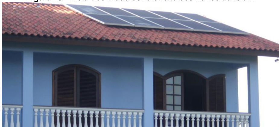
Figura 23 - Vista dos módulos fotovoltaicos no residencial 1
