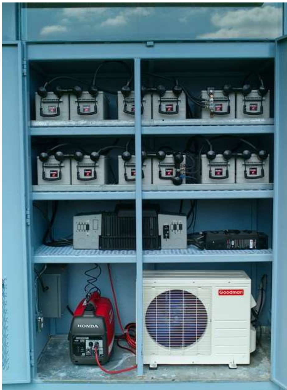
Figura 18 – Compartimento de equipamentos
