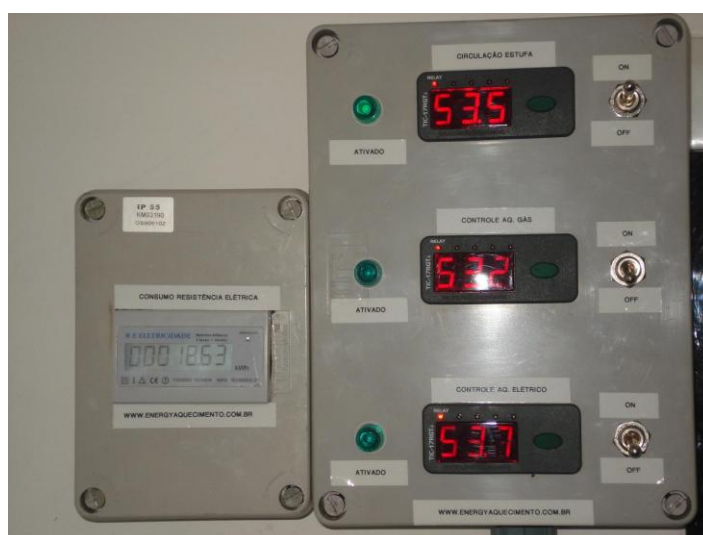
Figura 24 – Fotografia do painel do sistema de comando Fonte: Autoria própria.
