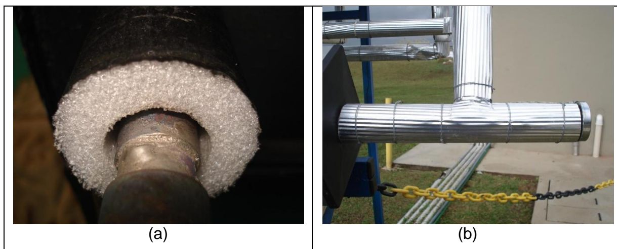
Figura 15 – Fotografia dos revestimentos das tubulações: (a) polietileno expandido; (b) alumínio corrugado.
