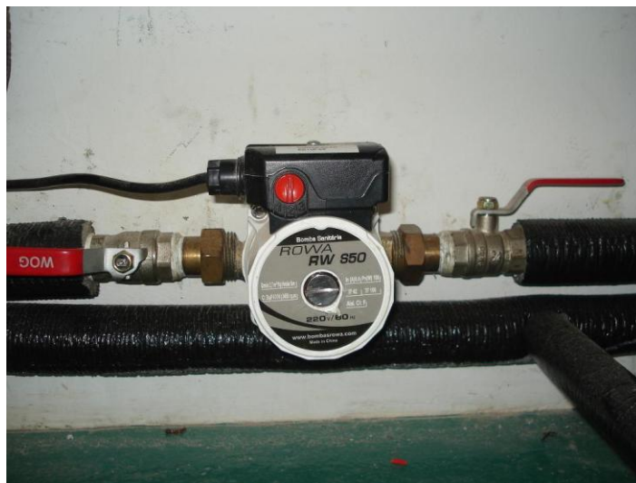
Figura 17 – Fotografia da bomba de circulação Fonte: Autoria própria.
