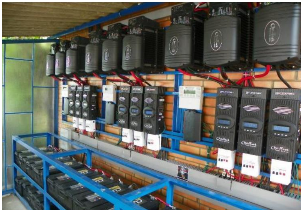
Figura 10 – Inversores, controladores de carga e baterias.
